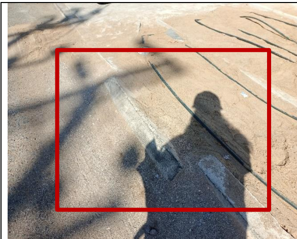
Fotografía N° 25 de 5-05-2023: solera tipo A desaplomada, tramo 4 calle Patricio Lynch entre Orella y Riquelme, altura 1373, acera poniente.
