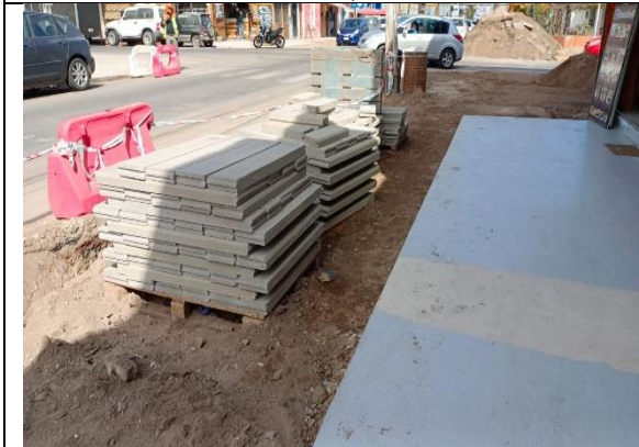
Fotografía N° 9 de 18-05-2023: acopio de soleras tipo C sin delimitación de seguridad y protección, tramo 2, calle Vivar, altura 1497, acera poniente.
