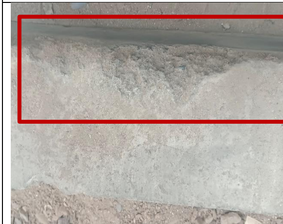
Fotografía N° 17 de 5-05-2023: solera tipo A perdida de aristas, tramo 4 calle Patricio Lynch entre Bulnes y Orella, altura 1201, acera poniente.
