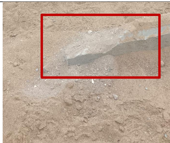
Fotografía N° 10 de 22-05-2023: solera tipo C quebrada, tramo 4 calle Patricio Lynch entre Bulnes y Orella, altura 1242, acera oriente.
