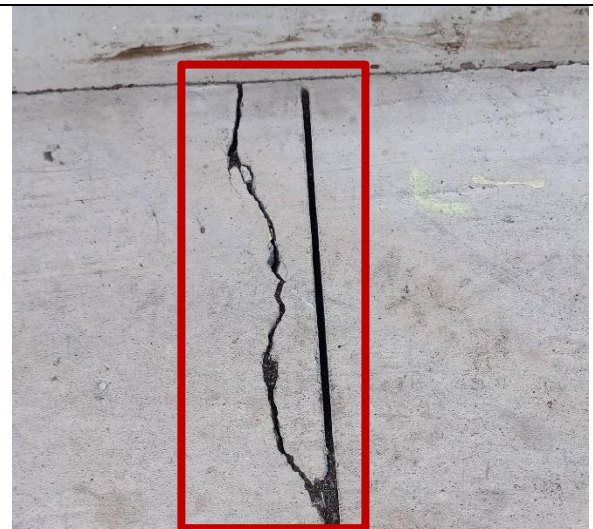
Fotografía N° 8 de 08-05-2023: Fisura diagonal en la junta, tramo 5, entre alturas 1201 y 1227 acera oriente.
