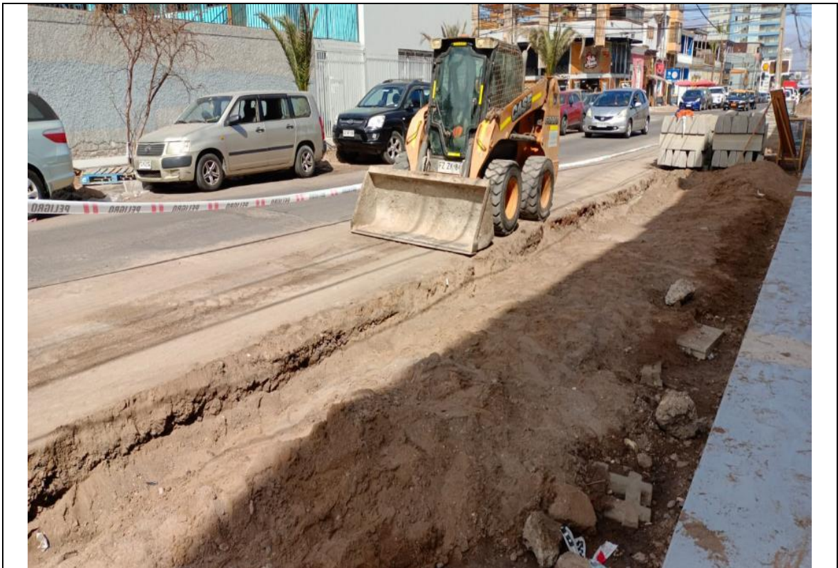
Fotografía N° 4 de 18-05-2023: se advierte angostamiento de vía en calle Vivar entre Riquelme y J.J. Pérez.
