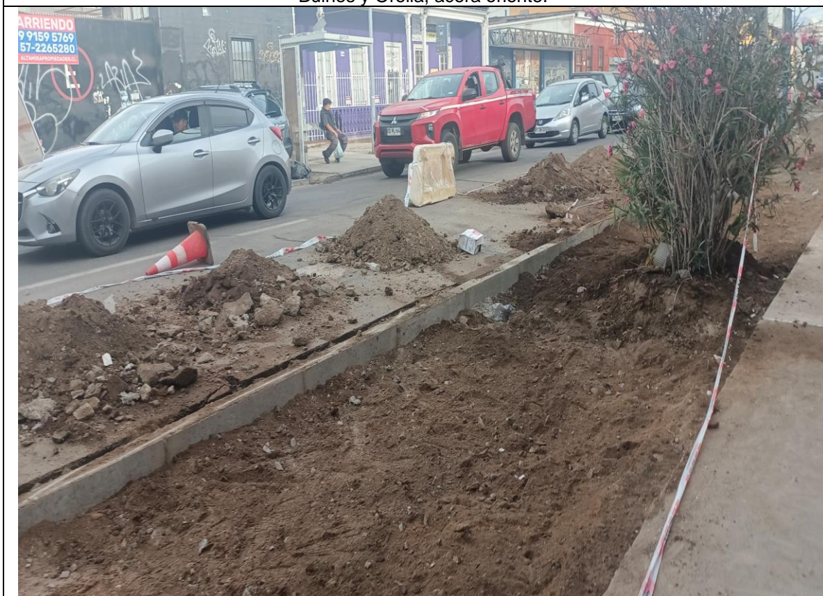
Fotografía N° 2 de 05-05-2023: cierre provisorio caído, tramo 1 calle Vivar entre Orella y Riquelme, acera poniente.
