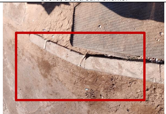
Fotografía N° 42 de 5-05-2023: soleras tipo A cortes irregulares y perdidas de aristas, tramo 6 itersección Anibal Pinto con Riquelme, acera norte / poniente.
