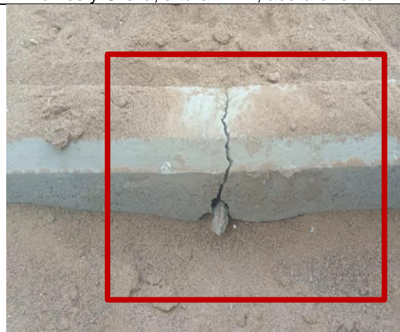
Fotografía N° 12 de 22-05-2023: solera tipo C quebrada, tramo 4 calle Patricio Lynch entre Bulnes y Orella, altura 1242, acera oriente.
