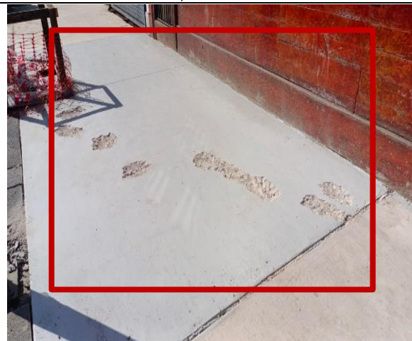
Fotografía N° 15 de 18-05-2023: rotura en hormigón en huellas socavadas, con aceras pintadas, tramo 1, calle Vivar entre Riquelme y J.J. Pérez, altura 1366, acera oriente.
