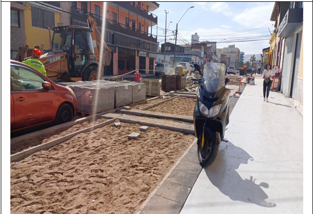
Fotografía N° 5 de 18-05-2023: ejecución de trabajos en vía, calle Vivar entre Riquelme y J.J. Pérez.
