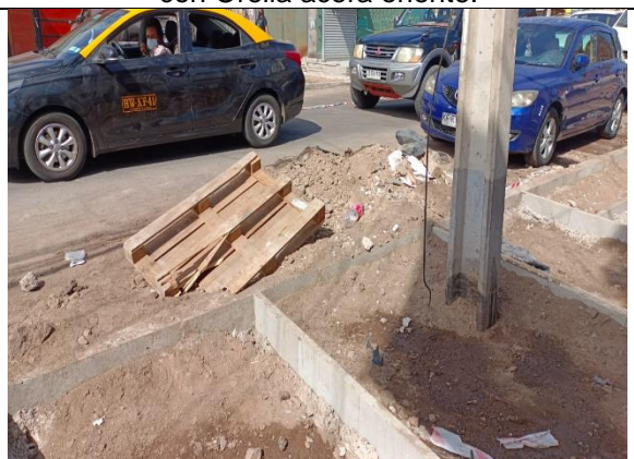
Fotografía N° 4 de 18-05-2023: se observan escombros en tramo 1, calle Vivar 1381 poniente.
