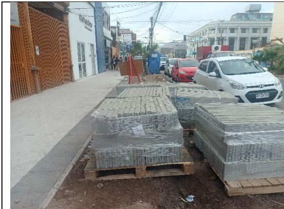
Fotografía N° 1 de 5-05-2023: acopio de soleras tipo C sin delimitación de seguridad, tramo 1, altura 1247, acera poniente.
