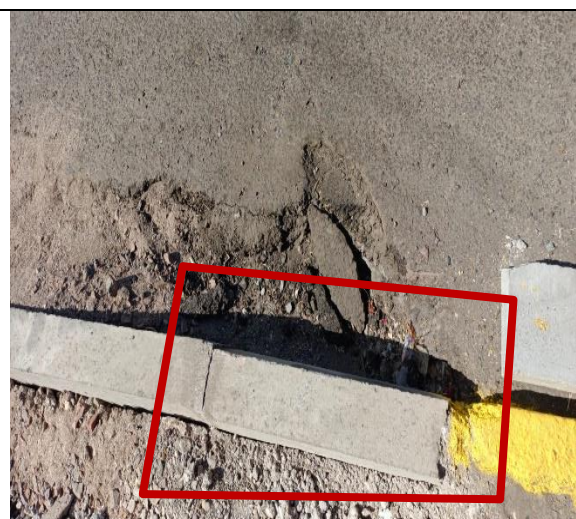
Fotografía N° 8 de 18-05-2023: solera tipo A sin emboquillado, tramo 3 calle Vivar entre Libertad y Cespedes, altura 1799, acera poniente.
