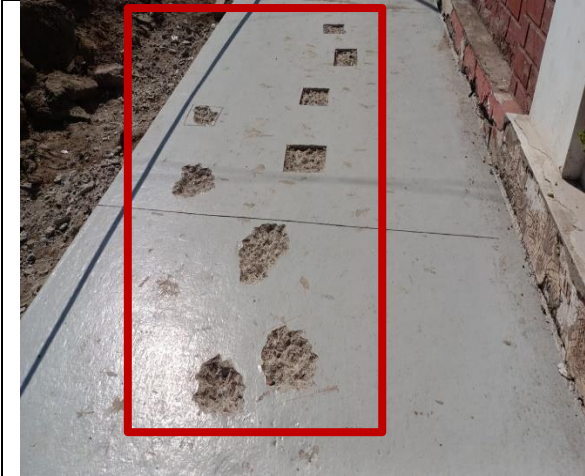
Fotografía N° 21 de 18-05-2023: rotura en hormigón en huellas socavadas, con aceras pintadas, tramo 3, calle Vivar entre J.J. Pérez y Manuel Rodríguez, altura 1764, acera oriente.
