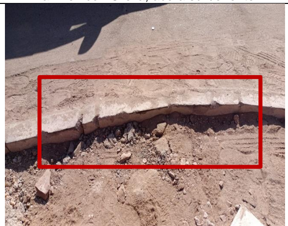
Fotografía N° 36 de 18-05-2023: soleras tipo A cortes irregulares, falta de emboquillado y con pérdida de aristas, tramo 2 intersección Vivar con Riquelme, acera sur /oriente.
