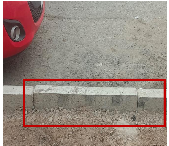
Fotografía N° 2 de 5-05-2023: soleras tipo A sin emboquillado, tramo 1 calle Eleuterio Ramirez entre Bulnes y Orella, altura 1231, acera poniente.
