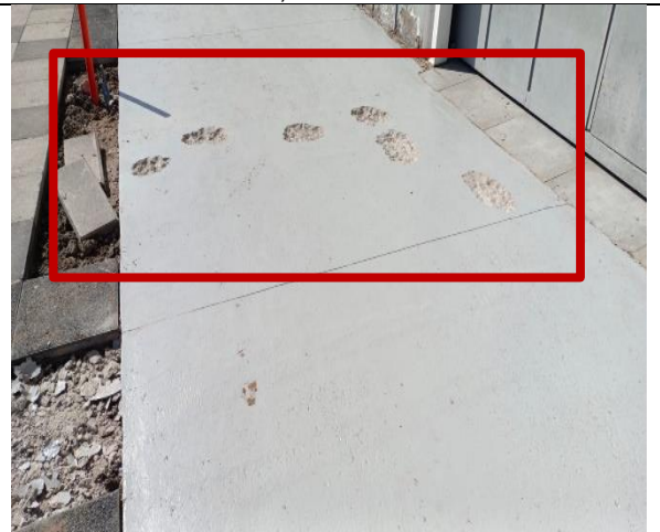
Fotografía N° 16 de 18-05-2023: rotura en hormigón en huellas socavadas, con aceras pintadas, tramo 1, calle Vivar entre Riquelme y J.J. Pérez, altura 1432, acera oriente.
