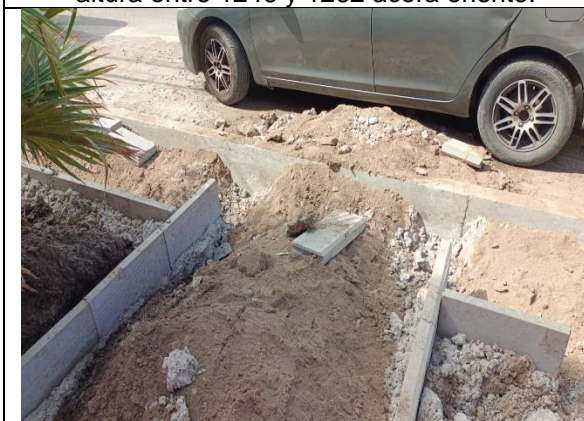
Fotografía N° 3 de 18-05-2023: se observan escombros en tramo 1, calle Vivar 1323 poniente.
