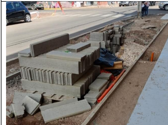
Fotografía N° 11 de 18-05-2023: acopio de soleras tipo C sin delimitación de seguridad y protección, tramo 3, calle Vivar, frente a colegio santuario sagrado corazon de jesus, acera poniente.
