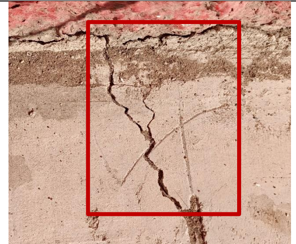
Fotografía N° 10 de 08-05-2023: Fisura en pavimento, tramo 6, Aníbal Pinto entre Orella y Riquelme, altura 1361, acera poniente.
