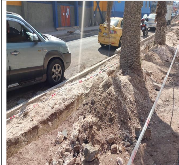
Fotografía N° 9 de 18-05-2023: se observan escombros en las jardineras, en tramo 3, calle Vivar entre Céspedes y González y Manuel Rodrigues, toda la cuadra oriente.
