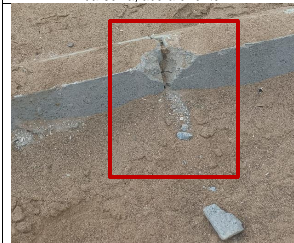
Fotografía N° 9 de 22-05-2023: solera tipo C perdida de arista, tramo 4 calle Patricio Lynch entre Bulnes y Orella, altura 1242, acera oriente.
