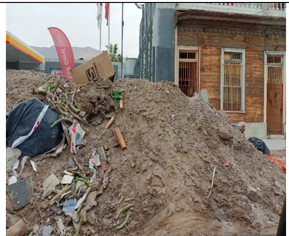
Fotografía N° 8 de 22-05-2023: se observan escombros en la acera durante la jornada de la mañana, tramo 3, calle Vivar frente a bencinera SHELL.
