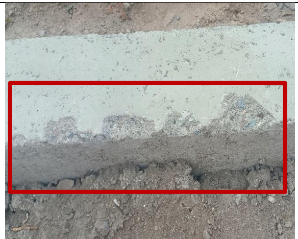
Fotografía N° 4 de 5-05-2023: solera tipo A perdida de aristas tramo 1 calle Orella entre E. Ramirez y Vivar, altura 623, acera poniente.
