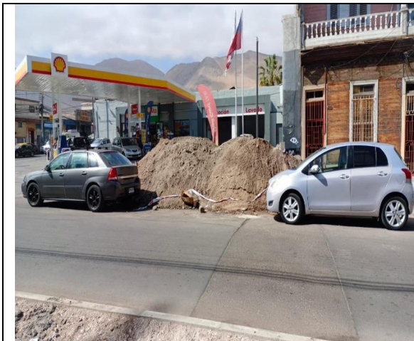
Fotografía N° 7 de 18-05-2023: se observan escombros en la acera durante la jornada de la mañana, tramo 3, calle Vivar frente a bencinera SHELL.
