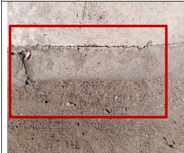
Fotografía N° 39 de 5-05-2023: soleras tipo A cortes irregulares, tramo 5 itersección Patricio Lynch J.J. Pérez, acera sur / oriente.
