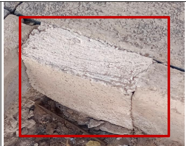
Fotografía N° 26 de 5-05-2023: terminación con cemento en solera tipo C, tramo 5 calle Patricio Lynch entre J.J. Pérez y Riquelme, altura 1420, acera oriente.
