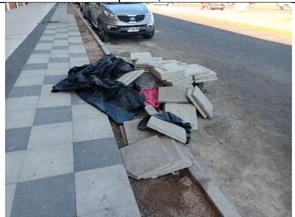
Fotografía N° 16 de 08-02-2023: acopio de baldosas sin protección y delimitación de seguridad en calzada, tramo 5, calle Patricio Lynch, altura 1580, acera oriente.
