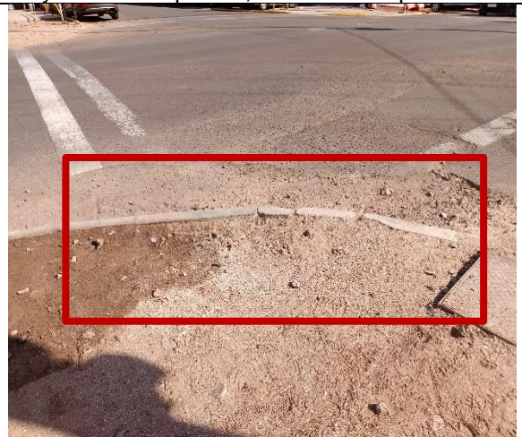
Fotografía N° 40 de 5-05-2023: soleras tipo A cortes irregulares, falta emboquillado y perdidas de aristas, tramo 6 itersección Anibal Pinto con Orella, acera sur / oriente.
