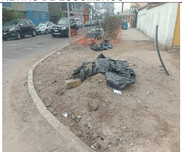
Fotografía N° 2 de 5-05-2023: se observan escombros, tramo 1, calle Eleuterio Ramirez, con Orella acera oriente.
