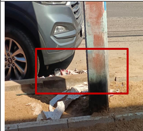
Fotografía N° 27 de 5-05-2023: solera tipo A desaplomada, tramo 5 calle Patricio Lynch entre J.J. Pérez y Riquelme, altura 1414, acera oriente.
