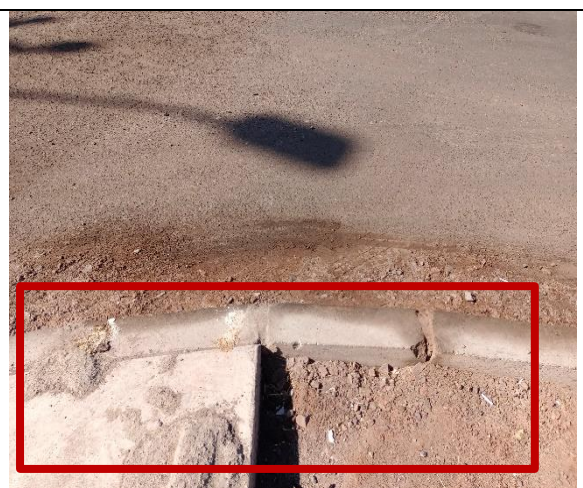
Fotografía N° 38 de 5-05-2023: soleras tipo A cortes irregulares, falta de emboquillado y con perdida de aristas, tramo 4 itersección Patricio Lynch con Riquelme, acera norte / poniente.
