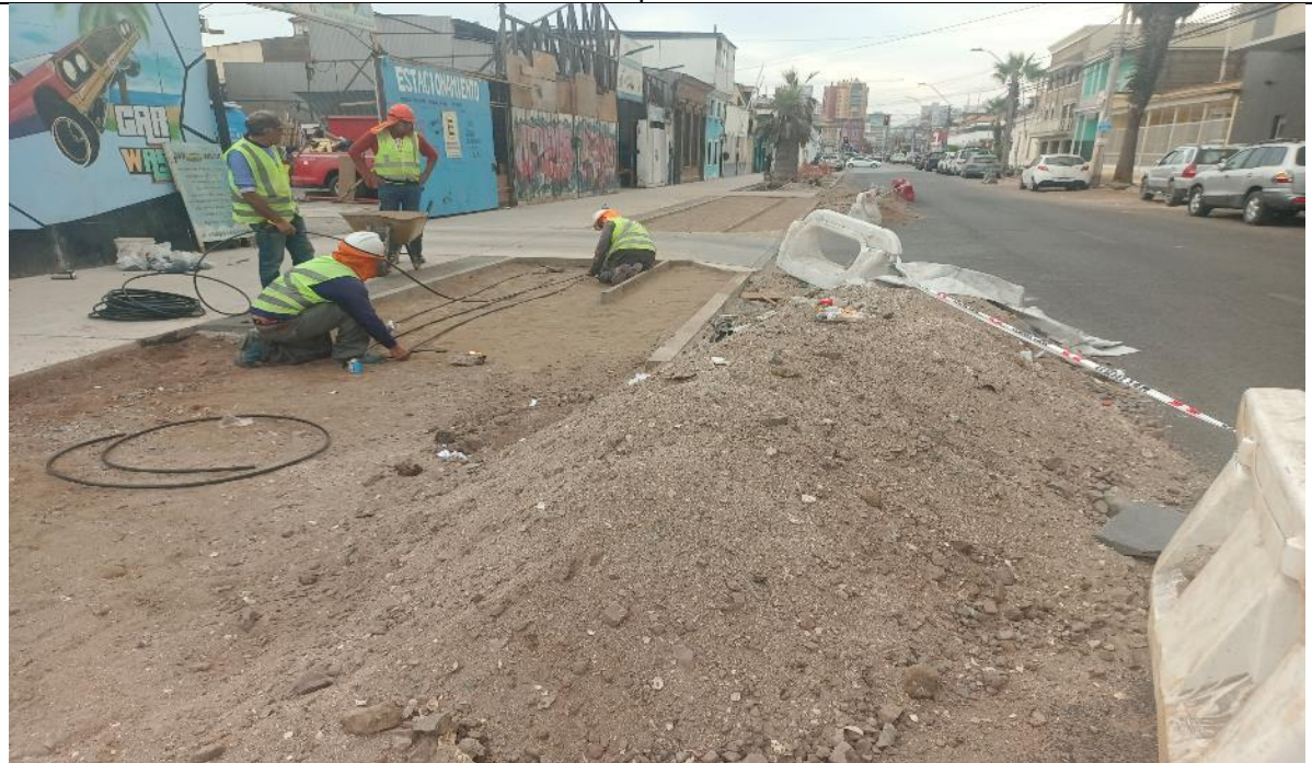
Fotografía N° 4 de 07-02-2023: cierre provisorio insuficiente, tramo 4 calle Patricio Lynch con Orella, acera poniente.
