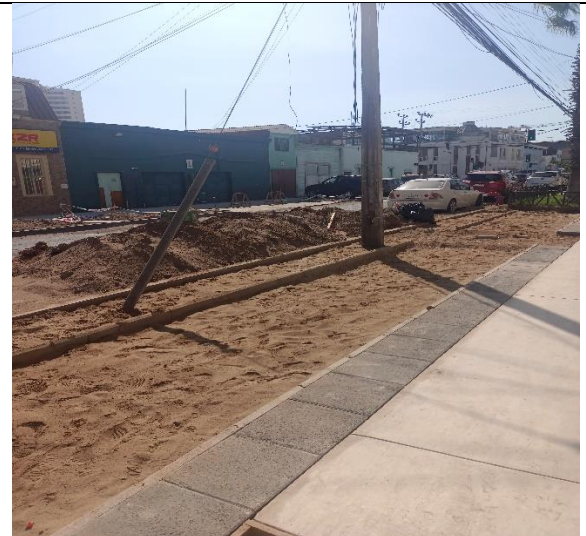
Fotografía N° 10 de 17-05-2023: se observan escombros en la calzada, tramo 4, calle Patricio Lynch entre Bulnes y Orella, altura 1242 y 1266 acera oriente.
