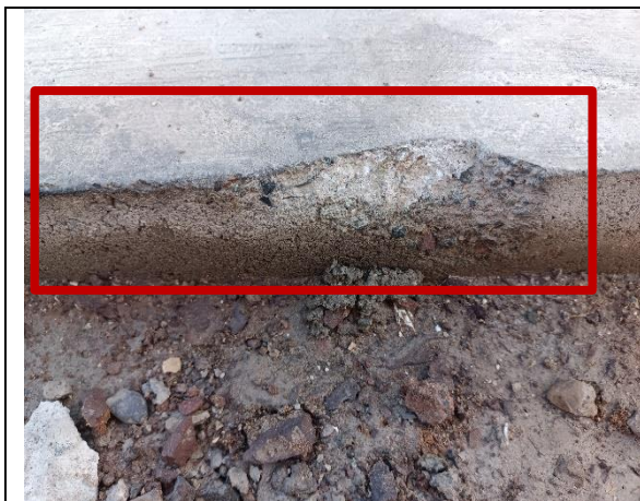
Fotografía N° 31 de 5-05-2023: soleras tipo A pérdida de aristas, tramo 6 calle Anibal Pinto entre Riquelme y Orella, altura 1366, acera oriente.
