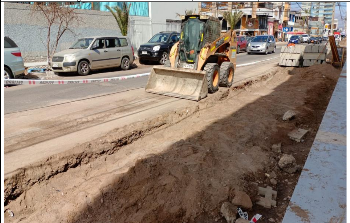
Fotografía N° 4 de 18-05-2023: maquinaria sin señal de tránsito PT-4, tampoco la señal de angostamiento a la derecha PTF-1b, calle Vivar entre Riquelme y J.J. Pérez.
