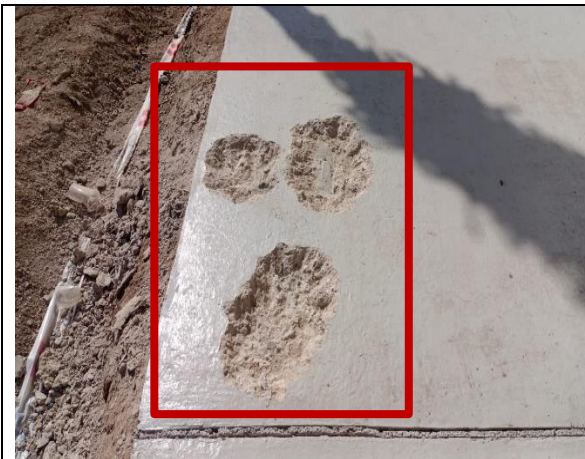
Fotografía N° 19 de 18-05-2023: rotura en hormigón en huellas socavadas, con aceras pintadas, tramo 2, calle Vivar entre J.J. Pérez y Manuel Rodríguez, altura 1552, acera oriente.
