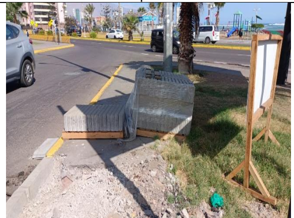
Fotografía N° 12 de 18-05-2023: acopio de soleras tipo C sin delimitación de seguridad y protección, tramo 3, calle Vivar, 1799, acera poniente.
