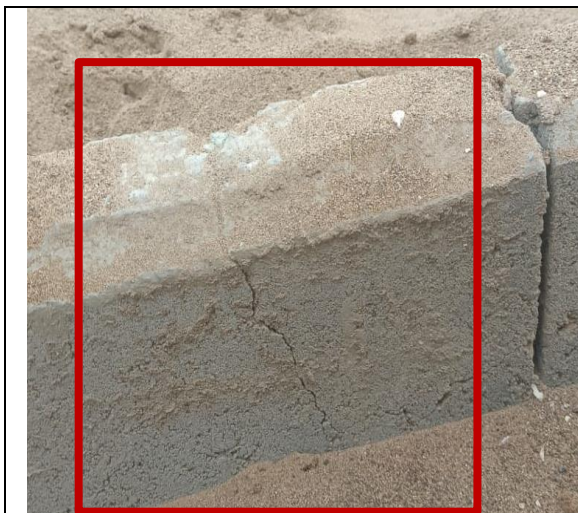
Fotografía N° 13 de 22-05-2023: solera tipo C agrietada, tramo 4 calle Patricio Lynch entre Bulnes y Orella, altura 1242, acera oriente.
