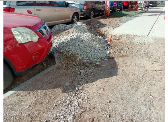
Fotografía N° 14 de 8-05-2023: se observan escombros acera, tramo 6, calle Aníbal Pinto, altura entre 1341 acera poniente.
