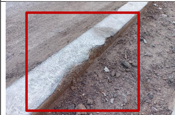
Fotografía N° 29 de 5-05-2023: soleras tipo A pérdida de aristas, tramo 6 calle Anibal Pinto entre Riquelme y Orella, altura 1382, acera oriente.
