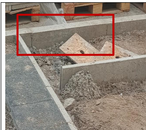
Fotografía N° 7 de 5-05-2023: solera tipo A sin emboquillado cubierta con mortero tramo 2 calle Vivar entre Riquelme y J.J. Pérez, frente a barsovia, acera oriente.
