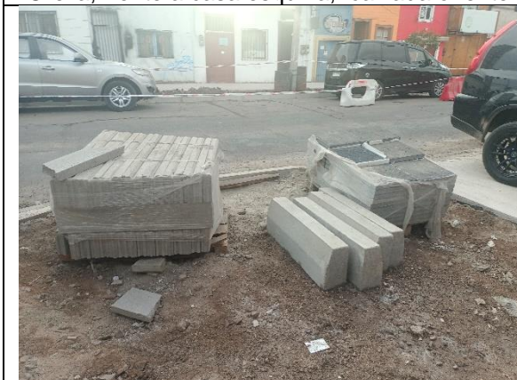
Fotografía N° 5 de 5-02-2023: acopio de soleras tipo C y baldosas sin delimitación de seguridad, soleras tipo A sin protección, tramo 1, calle Vivar, altura 1390, acera oriente.
