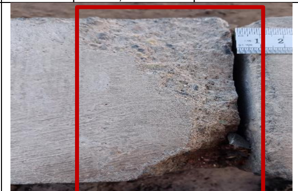
Fotografía N° 30 de 5-05-2023: soleras tipo A falta emboquillado y pérdida de aristas, tramo 6 calle Anibal Pinto entre Riquelme y Orella, altura 1374, acera oriente.
