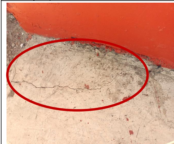
Fotografía N° 9 de 08-05-2023: Fisura en pavimento, tramo 5, entre alturas 1201 y 1227 acera oriente.
