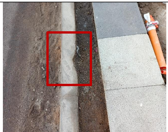
Fotografía N° 32 de 5-05-2023: soleras tipo A pérdida de aristas, tramo 6 calle Anibal Pinto entre Riquelme y Orella, frente edificio SENDA, acera oriente.
