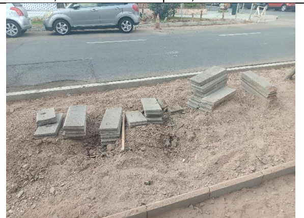
Fotografía N° 4 de 5-05-2023: acopio de soleras tipo C sin protección y delimitación de seguridad, tramo 1, calle Orella, altura 695, acera sur.
