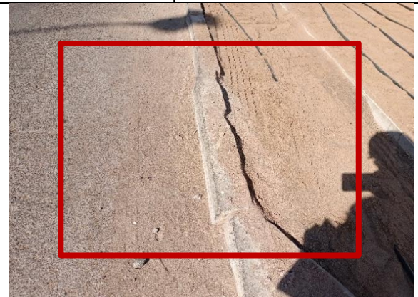
Fotografía N° 24 de 5-05-2023: solera tipo A desaplomada y pérdida de aristas, tramo 4 calle Patricio Lynch entre Orella y Riquelme, altura 1373, acera poniente.
