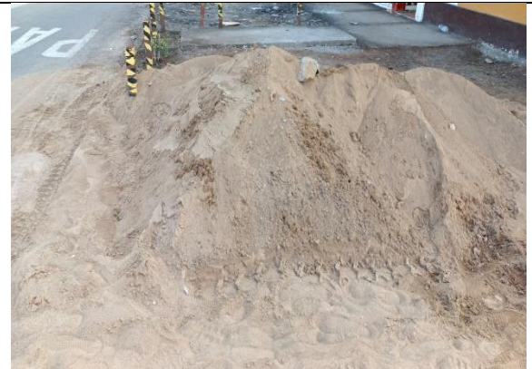
Fotografía N° 10 de 18-05-2023: acopio de material granular sin delimitación de seguridad y protección, tramo 2, calle Vivar con JJ. Perez, acera poniente.
