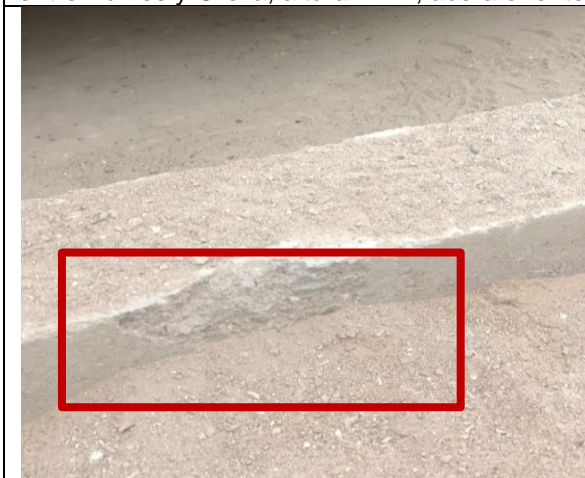
Fotografía N° 11 de 22-05-2023: solera tipo A perdida de arista, tramo 4 calle Patricio Lynch entre Bulnes y Orella, altura 1242, acera oriente.
