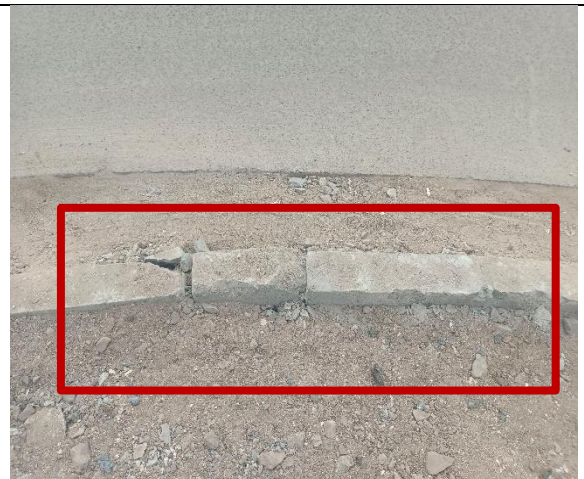
Fotografía N° 34 de 5-05-2023: soleras tipo A cortadas irregulares, falta de emboquillado y con pérdida de aristas, tramo 1 intersección Eleuterio Ramirez con Orella, acera sur /oriente.
