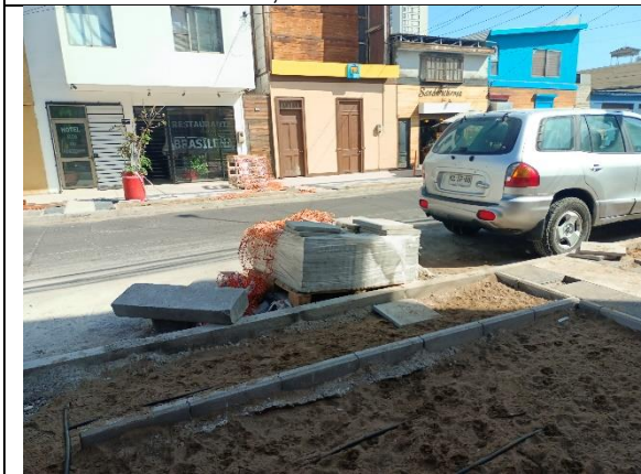
Fotografía N° 15 de 08-02-2023: acopio de baldosas sin delimitación de seguridad en calzada, tramo 5, calle Patricio Lynch, altura 1420, acera oriente.
