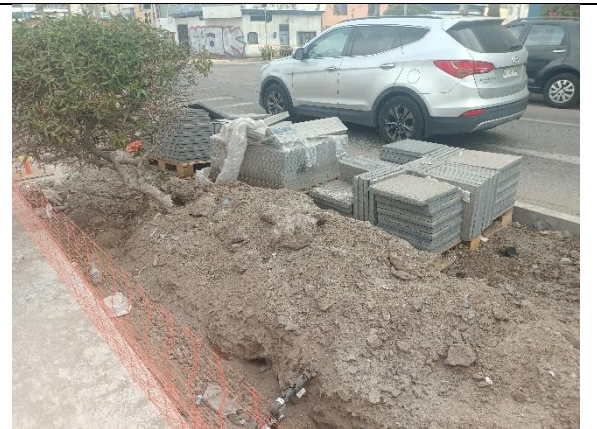
Fotografía N° 2 de 5-05-2023: acopio de soleras tipo C y baldosas sin protección y delimitación de seguridad, tramo 1, calle Eleuterio Ramirez con Orella, frente a casa esquina, acera oriente.
