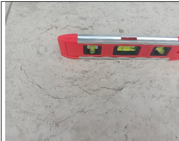
Fotografía N° 13 de 05-05-2023: Huellas socavadas con fisuras de contracción, tramo 1, calle Vivar entre Orella y Riquelme, alturas 1308 al 1366, acera oriente.
