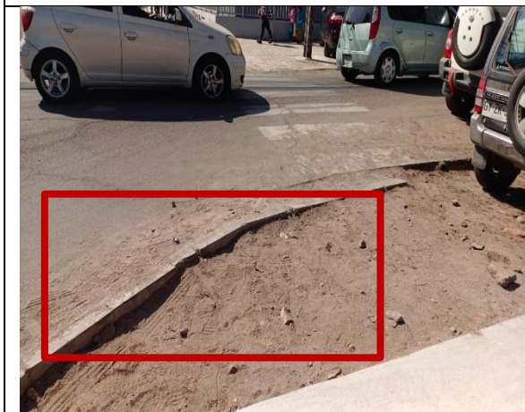
Fotografía N° 35 de 18-05-2023: soleras tipo A cortes irregulares, falta de emboquillado y con pérdida de aristas, tramo 1 intersección Eleuterio Ramirez con Orella, acera sur /oriente.
