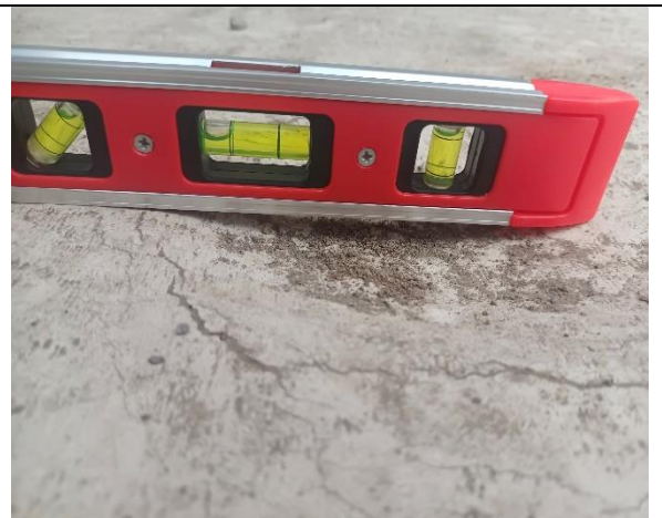
Fotografía N° 14 de 05-05-2023: Huellas socavadas con fisuras de contracción, tramo 1, calle Vivar entre Orella y Riquelme, alturas 1308 al 1366, acera oriente.
