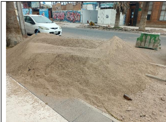
Fotografía N° 13 de 04-02-2023: acopio de material granular sin protección y delimitación de seguridad, tramo 4, calle Patricio Lynch, altura 1266, acera oriente.
