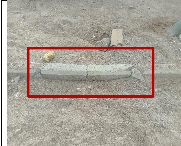
Fotografía N° 15 de 5-05-2023: solera tipo C quebrada, tramo 4 calle Patricio Lynch entre Bulnes y Orella, altura 1250 al 1266, acera oriente.
