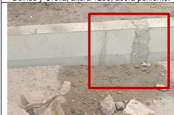
Fotografía N° 5 de 5-05-2023: solera tipo A reparada con cemento tramo 1 calle Vivar entre Orella y Riquelme, altura 1365, acera poniente.
