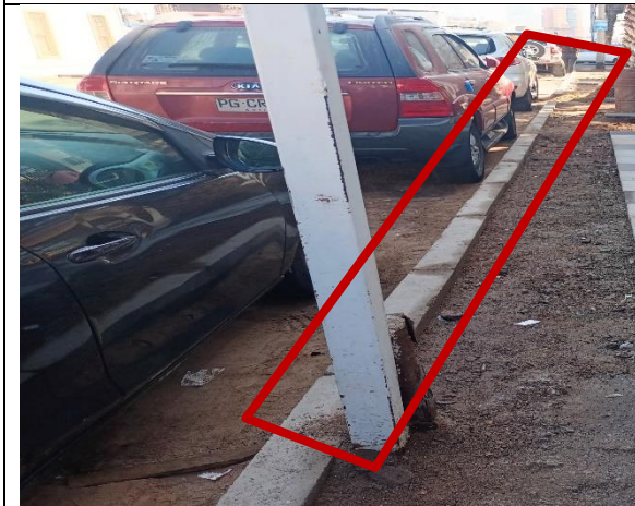
Fotografía N° 21 de 5-05-2023: solera tipo A falta emboquillado, tramo 4 calle Patricio Lynch entre Orella y Riquelme desde altura 1340 al 1310, acera oriente.
