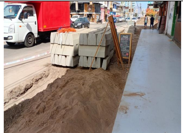
Fotografía N° 8 de 18-05-2023: acopio de soleras tipo A sin delimitación de seguridad y protección, tramo 2, calle Vivar, altura 1475, acera poniente.
