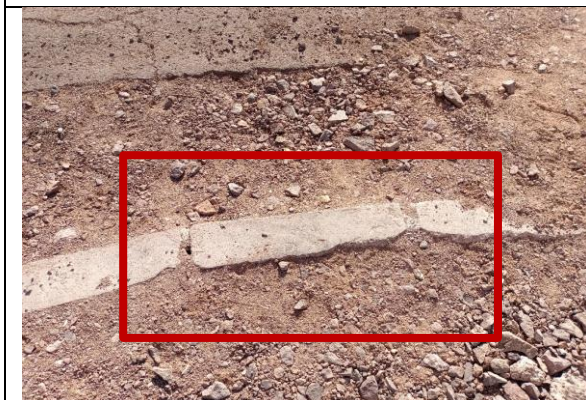
Fotografía N° 41 de 5-05-2023: soleras tipo A cortes irregulares y perdidas de aristas, tramo 6 itersección Anibal Pinto con Orella, acera sur / poniente.
