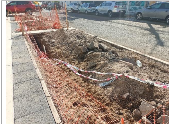
Fotografía N° 13 de 8-05-2023: se observan escombros en las jardineras, tramo 4, calle Patricio Lynch, altura entre 1233 y 1273 acera poniente.
