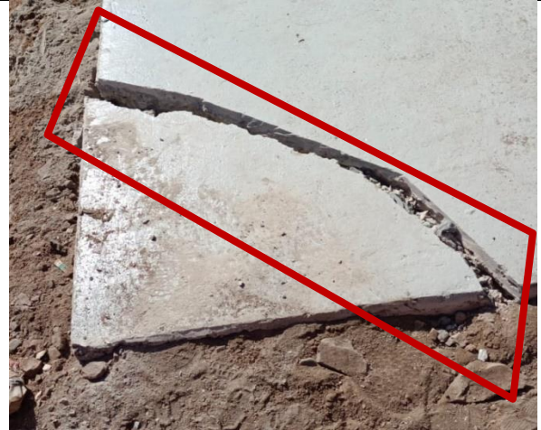
Fotografía N° 22 de 18-05-2023: 3 Roturas en pavimentos que ya cuentan con pintura de terminación, tramo 3, calle Vivar entre J.J. Pérez y Manuel Rodríguez, altura 1596, acera oriente.
