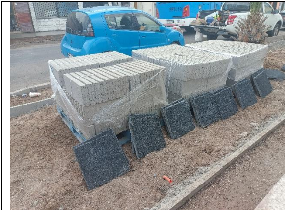
Fotografía N° 7 de 5-05-2023: acopio de soleras tipo C sin delimitación de seguridad y balsosas sin protección, tramo 2, calle vivir frente a colegio maria auxiliadora, acera oriente.
