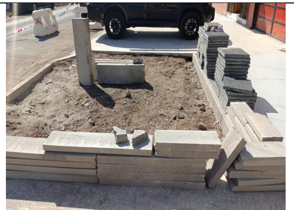
Fotografía N° 6 de 18-02-2023: acopio de soleras tipo C y baldosas sin delimitación de seguridad y protección, tramo 1, calle Vivar, altura 1398, acera oriente.
