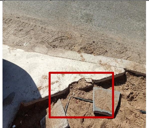
Fotografía N° 24 de 08-05-2023: 3 Roturas en pavimentos que ya cuentan con pintura de terminación, tramo 4, Patricio Lynch entre Orella Riquelme, altura 1339, acera poniente.
