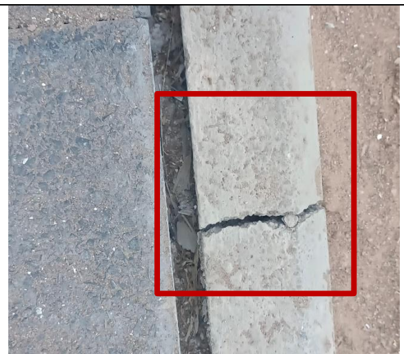
Fotografía N° 14 de 5-05-2023: solera tipo C quebrada, tramo 4 calle Patricio Lynch entre Bulnes y Orella, altura 1242, acera oriente.
