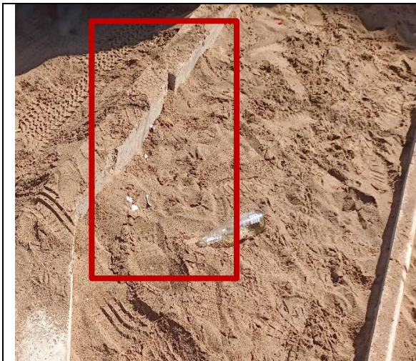
Fotografía N° 19 de 5-05-2023: solera tipo A falta emboquillado quedando con material granular en el encuentro entre soleras, tramo 4 calle Patricio Lynch entre Orella y Riquelme, altura 1380, acera oriente.
