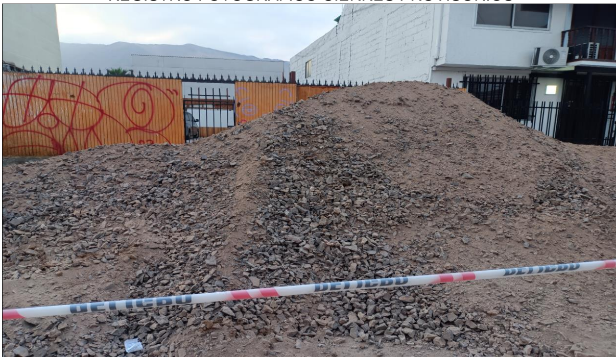
Fotografía N° 1 de 10-05-2023: cierre provisorio insuficiente, tramo 1 calle Eleuterio Ramirez entre Bulnes y Orella, acera oriente.
