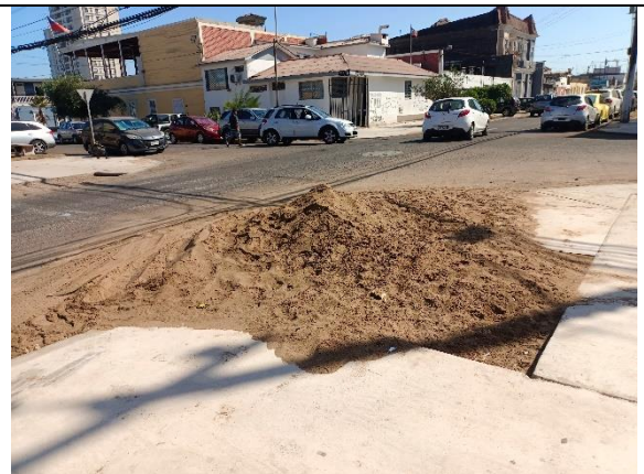
Fotografía N° 14 de 05-02-2023: acopio de material granular sin protección y delimitación de seguridad, tramo 5, calle Patricio Lynch con Ernesto Riquelme, acera oriente.
