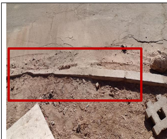
Fotografía N° 37 de 18-05-2023: soleras tipo A cortes irregulares, falta de emboquillado y con perdida de aristas, tramo 2 itersección Vivar con J.J Pérez, acera sur /oriente.
