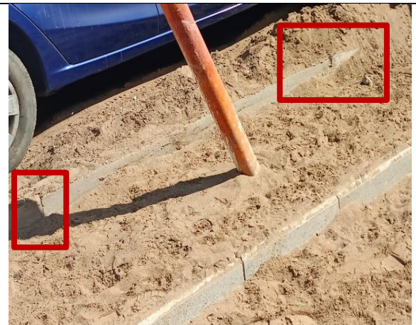
Fotografía N° 18 de 5-05-2023: solera tipo A falta emboquillado quedando con material granular en el encuentro entre soleras, tramo 4 calle Patricio Lynch entre Orella y Riquelme, altura 1364, acera oriente.
