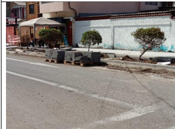
Fotografía N° 3 de 18-05-2023: acopio de soleras tipo C y baldosas sin protección y delimitación de seguridad, tramo 1, calle Eleuterio Ramirez con Orella, frente a casa esquina, calzada oriente.
