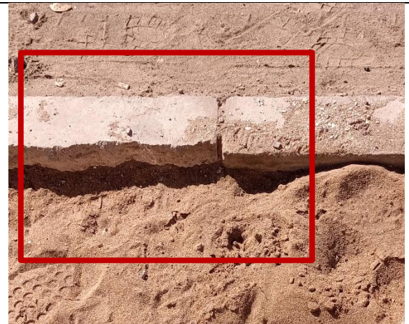
Fotografía N° 22 de 5-05-2023: solera tipo A falta emboquillado en tramo completo y pérdida de arista, altura entre 1351 y 1363 tramo 4 calle Patricio Lynch entre Orella y Riquelme, acera poniente.
