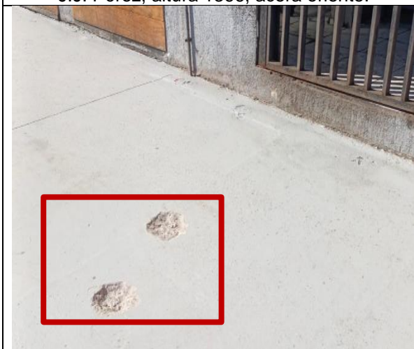
Fotografía N° 17 de 05-05-2023: Huellas socavadas con fisuras de contracción, tramo 1, altura 1366, acera oriente.
