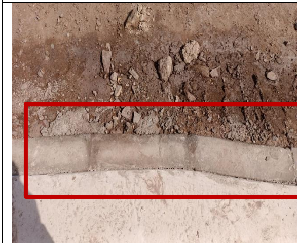
Fotografía N° 33 de 5-05-2023: soleras tipo A cortes irregulares, tramo 1 intersección Eleuterio Ramirez con Orella, acera norte / oriente.
