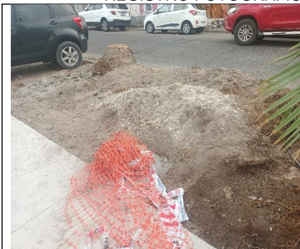
Fotografía N° 1 de 5-05-2023: se observan escombros, tramo 1, calle Eleuterio Ramirez, altura entre 1246 y 1262 acera oriente.
