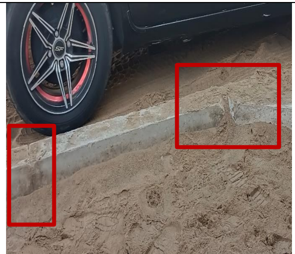
Fotografía N° 20 de 5-05-2023: solera tipo A falta emboquillado quedando con material granular en el encuentro entre soleras, tramo 4 calle Patricio Lynch entre Orella y Riquelme, altura 1364, acera oriente.
