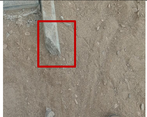
Fotografía N°16 de 5-05-2023: solera tipo C quebrada, tramo 4 calle Patricio Lynch entre Bulnes y Orella, altura 1250 al 1266, acera oriente.
