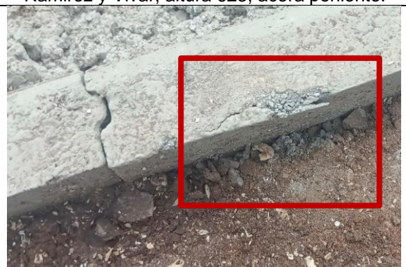
Fotografía N° 6 de 5-05-2023: solera tipo C perdida de arista, tramo 2 calle Vivar entre Riquelme y J.J. Pérez, frente a colegio maria auxiliadora, acera oriente.
