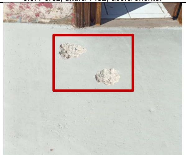
Fotografía N° 18 de 05-05-2023: Huellas socavadas con fisuras de contracción, tramo 1, altura 1366, acera oriente.
