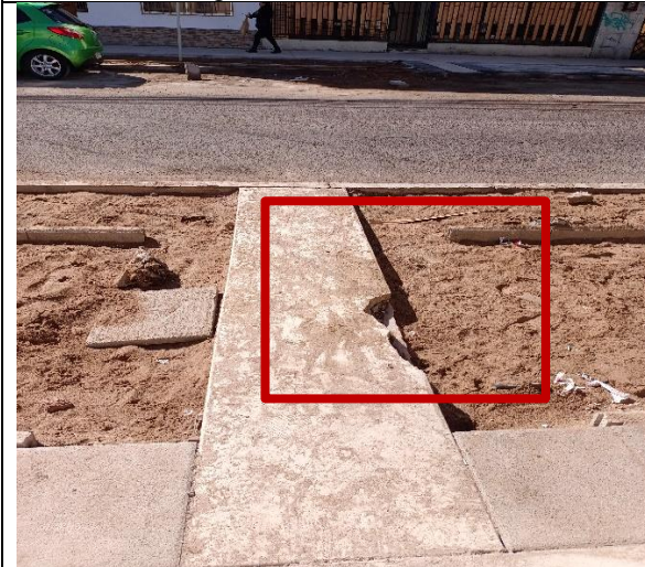
Fotografía N° 23 de 08-05-2023: 3 Roturas en pavimentos que ya cuentan con pintura de terminación, tramo 4, Patricio Lynch entre Orella Riquelme, altura 1321, acera poniente.
