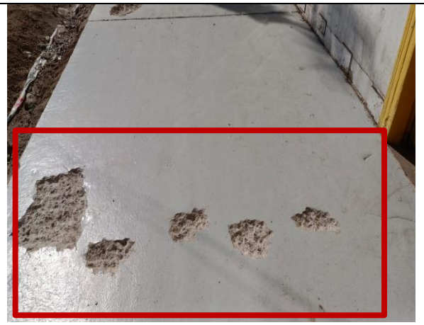
Fotografía N° 20 de 18-05-2023: rotura en hormigón en huellas socavadas, con aceras pintadas, tramo 2, calle Vivar entre J.J. Pérez y Manuel Rodríguez, altura 1552, acera oriente.
