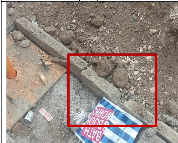
Fotografía N° 3 de 5-05-2023: solera tipo C quebrada tramo 1 calle Eleuterio Ramirez entre Bulnes y Orella, altura 1253, acera poniente.
