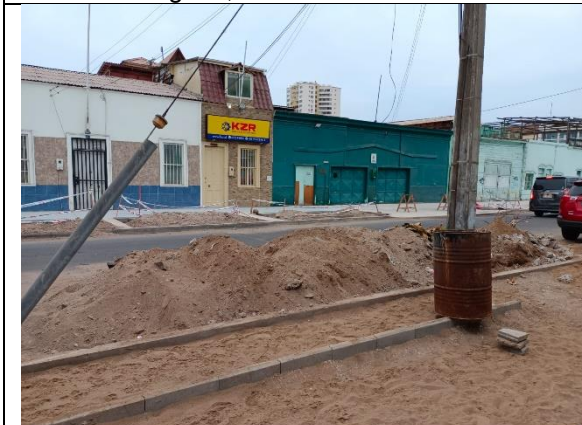
Fotografía N° 11 de 22-05-2023: se observan escombros en la calzada, tramo 4, calle Patricio Lynch entre Bulnes y Orella, altura 1242 y 1266 acera oriente.
