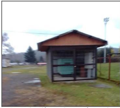
Generador Eléctrico iluminación Estadio
