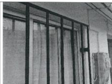
Protección sólo con anticorrosivo
