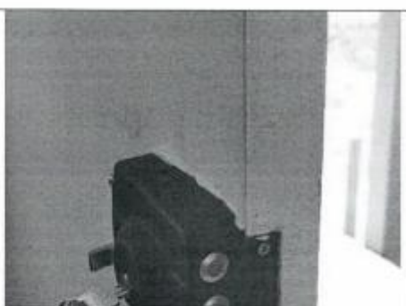
Se aprecia sólo una mano de pintura en puerta.
