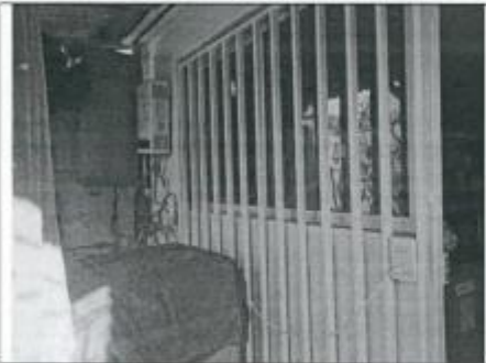
Falta de sellos en ventanas y sin botaguas, enchufes exteriores no cumplen norma
