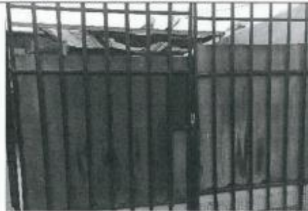
Reparación de reja de forma muy precaria. Se encuentra descuadrada y falta de tratamiento, anticorrosivo y pintura
