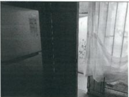
Puerta no cumple con lo especificado.
