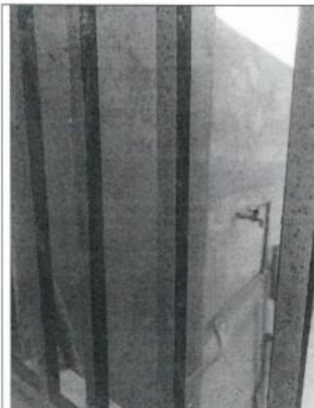
Protección de Reja pintado en tres cantos y sólo con anticorrosivo. Se aprecia canto junto a ventana sin pintar.
