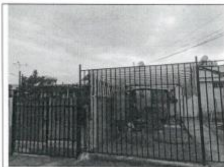
Idem imagen precedente. Falta de tapas en pilares.
