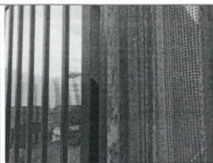
Idem imagen precedente. Falta de tapas en pilares y encuentro con reja en volcometal.
