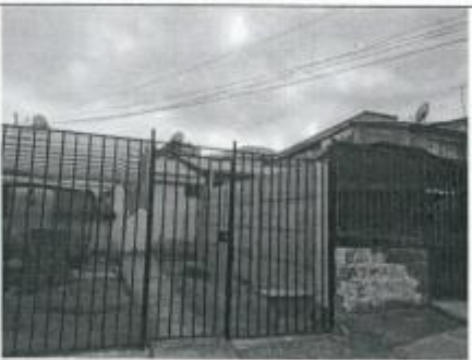
Realizan encuentro de medianero con reja con internit y volcometal, lo que no se encuentra especificado. Se solicitó realizar encuentro con estructura metálica. Realizado.
