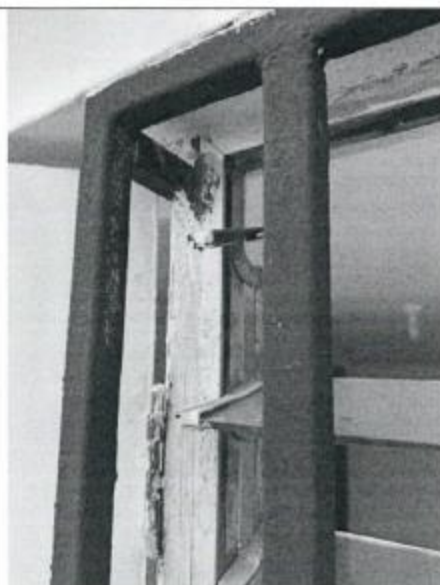
Misma protección pintada en tres cantos. Se aprecia sólo anticorrosivo en una mano, no cumple las EE.TT.
