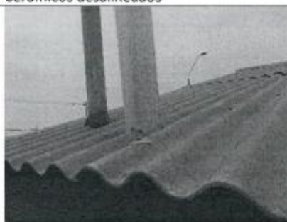
Falta de sello en Tubería de evacuación de gases del calefón.
