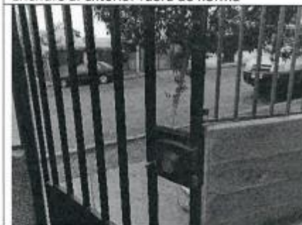
Realizaron cambio de chapa, una nueva por una re utilizada instalada anteriormente.
