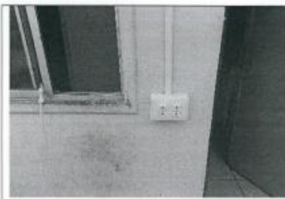
Enchufe exterior fuera de norma
