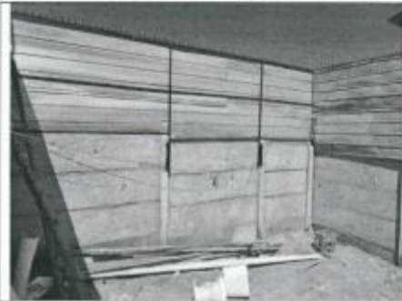
Luego de que Elsaed realizara trabajos, lo que no cumple ningún ítem ni EE.TT.
