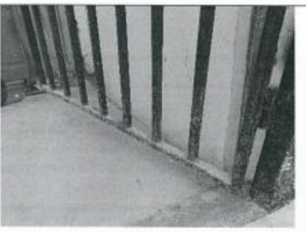
Reparación reja, no se aprecia tratada y pintura en mal estado
