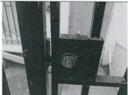
Desprolijidad en pintura, chapa manchada.
