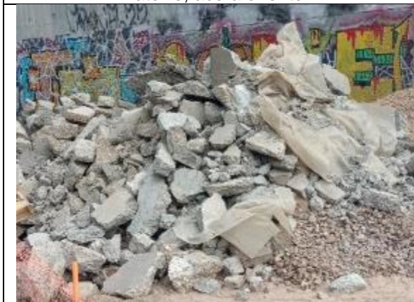
Fotografía N° 5 de 31-02-2023: se observan escombros en la acera durante la jornada de la mañana, calle Aníbal Pinto con Grumete Bolados, acera poniente.
