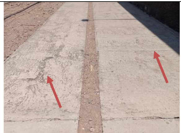
Fotografía N° 26 de 15-02-2023: Manchas en aceras de hormigón, tramo 11 calle Aníbal Pinto entre Grumete Bolados y Wilson, acera poniente.
