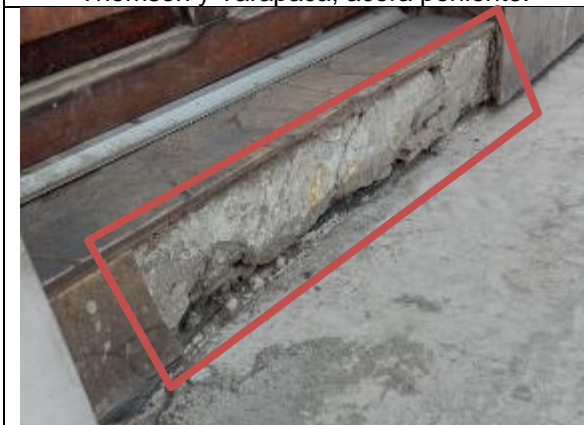
Fotografía N° 3 de 20-02-2023: Daño en fachada, tramo 8 calle Patricio Lynch entre Almirante Latorre y Thomson, acera poniente
