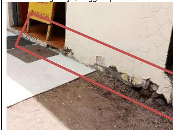
Fotografía N° 11 de 31-01-2023: Daño en fachada, tramo 11 calle Aníbal Pinto entre Zegers y Wilson oriente.
