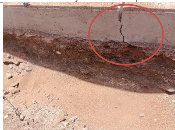
Fotografía N° 16 de 15-02-2023: Grieta en hormigón en acera, tramo 11 calle Aníbal Pinto entre O'Higgins y Zegers acera oriente.
