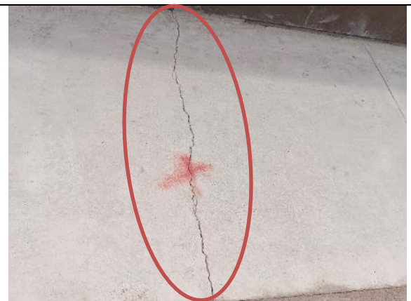
Fotografía N° 20 de 07-02-2023: Grieta en hormigón en acera, tramo 11 calle Aníbal Pinto entre Zegers y Wilson acera oriente.
