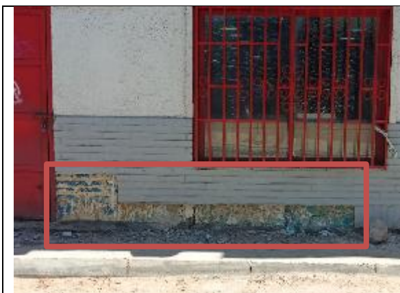
Fotografía N° 1 de 20-02-2023: Daño en fachada, tramo 7 calle Patricio Lynch entre Thomson y Tarapacá, acera poniente.
