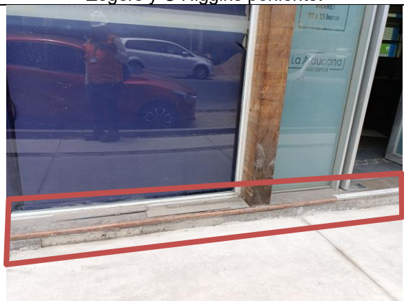
Fotografía N° 12 de 31-01-2023: Daño en fachada, tramo 11 calle Aníbal Pinto entre Zegers y Wilson oriente.
