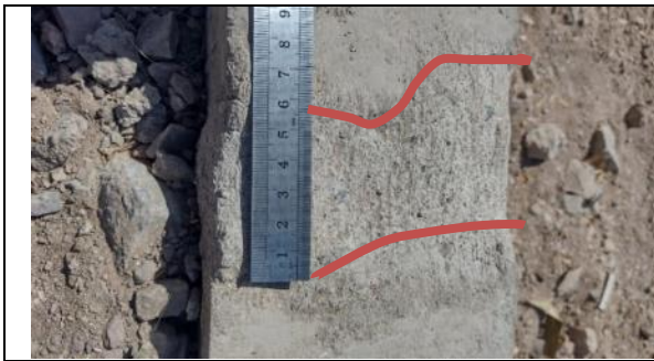
Fotografía N° 9 de 21-02-2023: separación entre soleras superior a 5mm, tramo 11 calle Aníbal Pinto entre Grumete Bolados y Zegers, acera poniente.
