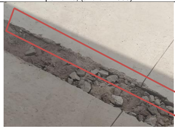
Fotografía N° 30 de 07-02-2023: Perdida de arista en aceras de hormigón, tramo 10 calle Aníbal Pinto entre Gorostiaga y Wilson, acera poniente.
