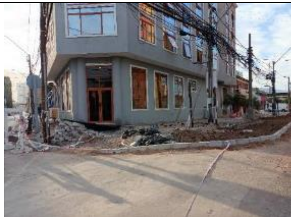
Fotografía N° 4 de 06-02-2023: se mantienen escombros por 72 horas en la acera, respecto de la fotografía N°5, tramo 8 calle Patricio Lynch con Almirante Latorre, acera oriente.
