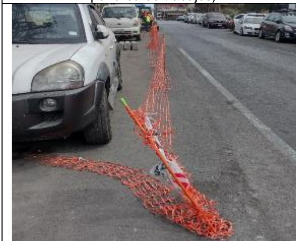
Fotografía N° 5 de 31-01-2023: cierre provisorio, tramo 10 calle Aníbal Pinto entre Gorostiaga y Wilson, acera poniente.
