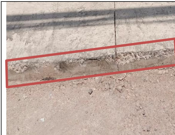
Fotografía N° 31 de 07-02-2023: Perdida de arista en aceras de hormigón, tramo 11 calle Aníbal Pinto entre Wilson y Grumete Bolados, acera poniente.
