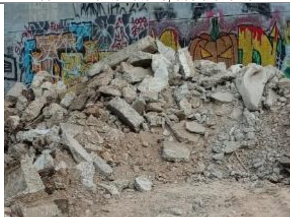
Fotografía N° 6 de 03-02-2023: se mantienen escombros por 72 horas en la acera, respecto de la fotografía N°7, calle Aníbal Pinto con Grumete Bolados, acera poniente.
