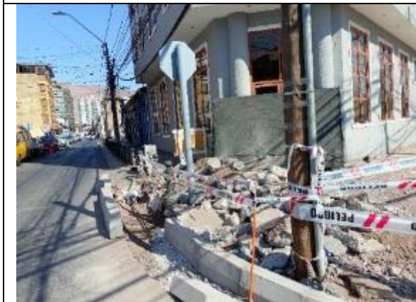
Fotografía N° 3 de 03-02-2023: se observan escombros en la acera durante la jornada de la mañana, tramo 8 calle Patricio con Almirante Latorre, acera oriente.
