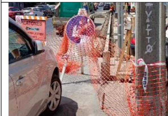
Fotografía N° 5 de 31-01-2023: letrero indicativo tapado, además no se encuentran instalados los letreros de señalización de trabajos en la vía PT-1 y PT-2, tampoco la señal de angostamiento a la derecha PTF-1b, tramo 9 calle Aníbal Pinto entre Gorostiaga y Wilson, acera poniente.
