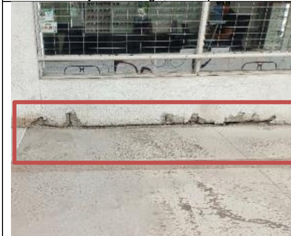
Fotografía N° 9 de 31-01-2023: Daño en fachada, tramo 11 calle Aníbal Pinto entre Zegers y O'Higgins poniente.
