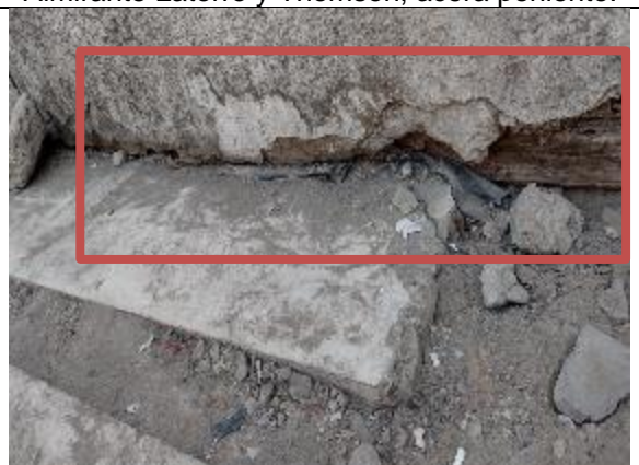
Fotografía N° 4 de 20-02-2023: Daño en fachada, tramo 8 calle Patricio Lynch entre Almirante Latorre y Thomson, acera poniente
