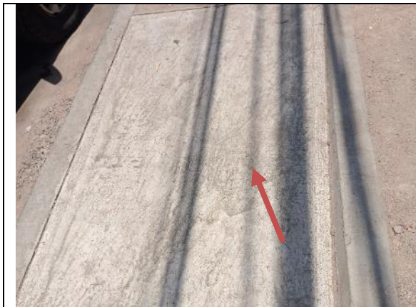
Fotografía N° 25 de 15-02-2023: Manchas en rampa de hormigón, tramo 11 calle Aníbal Pinto entre Zegers y Grumete Bolados, acera poniente.
