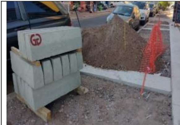
Fotografía N° 1 de 21-02-2023: acopio de soleras y material granular sin protección y sin delimitación de seguridad, tramo 8 calle Patricio Lynch entre Almirante Latorre y Gorostiaga, acera poniente.
