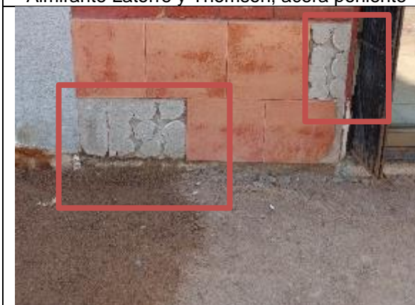
Fotografía N° 5 de 20-02-2023: Daño en fachada, tramo 8 calle Patricio Lynch entre Gorostiaga y Almirante Latorre, acera oriente.
