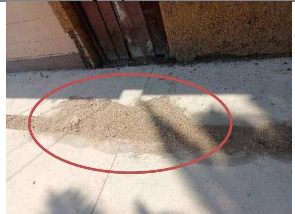
Fotografía N° 22 de 07-02-2023: Hormigón Desconchado en acera, tramo 11 calle Aníbal Pinto entre O'Higgins y Zegers acera oriente (altura N°1024).
