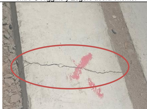
Fotografía N° 18 de 07-02-2023: Grieta en hormigón en acera, tramo 11 calle Aníbal Pinto entre Zegers y Wilson acera oriente.
