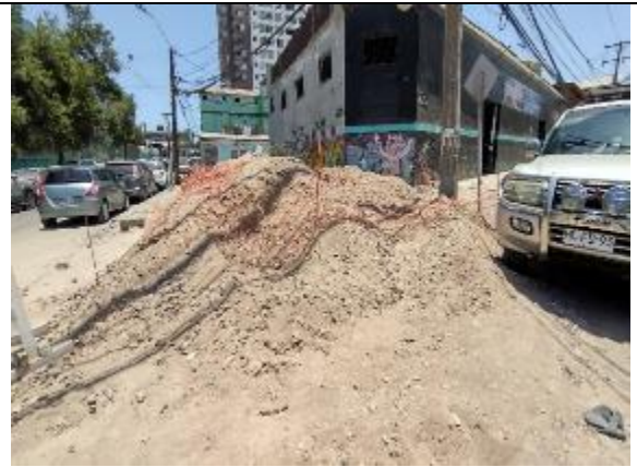
Fotografía N° 8 de 21-02-2023: acopio de material granular sin protección y sin delimitación de seguridad, calle Aníbal Pinto con Grumete Bolados, acera poniente.
