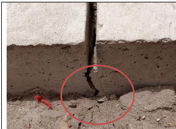
Fotografía N° 19 de 07-02-2023: Grieta en hormigón en acera, tramo 11 calle Aníbal Pinto entre Zegers y Wilson acera oriente.
