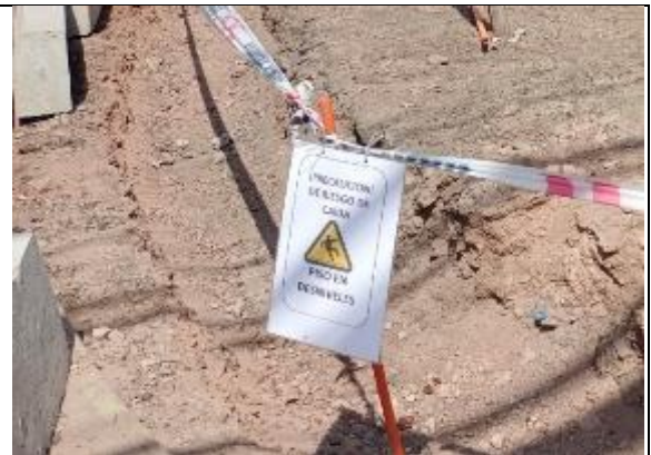
Fotografía N° 2 de 31-01-2023 letrero de advertencia de peligro no cumple con lo indicado en el MST (PTE-12), tramo 9 calle Aníbal Pinto entre Bolívar y San Martín, acera poniente.
