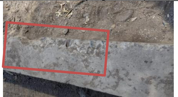
Fotografía N° 12 de 21-02-2023: pérdida de aristas, tramo 11 calle Aníbal Pinto entre Zegers y Wilson, acera oriente.
