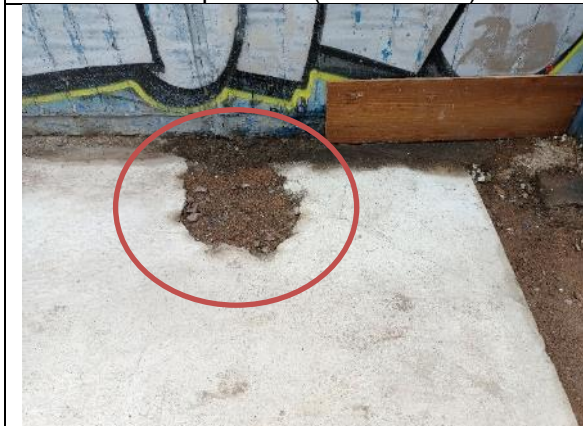
Fotografía N° 23 de 07-02-2023: Hormigón Desconchado en acera, tramo 11 calle Aníbal Pinto entre Zegers y Wilson acera oriente (altura N°962).
