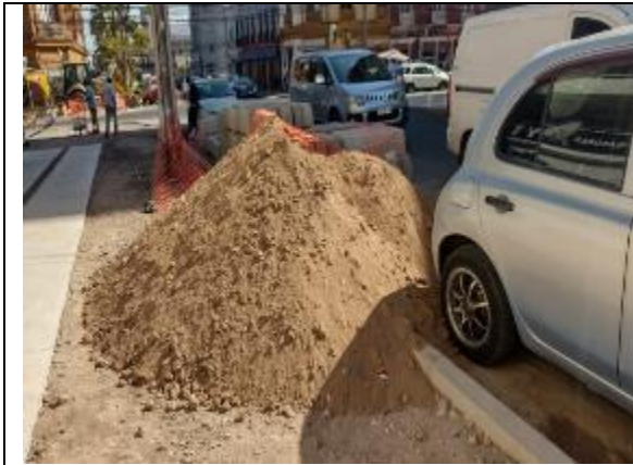
Fotografía N° 7 de 21-02-2023: acopio de material granular sin protección y sin delimitación de seguridad, tramo 9 calle Aníbal Pinto entre San Martín y Serrano, acera poniente.
