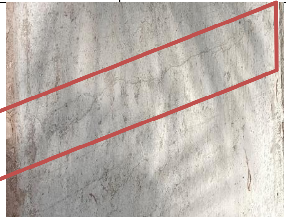
Fotografía N° 28 de 07-02-2023: Fisura en aceras de hormigón, tramo 11 calle Aníbal Pinto entre Grumete Bolados y Zegers, acera poniente, (altura N° 955)
