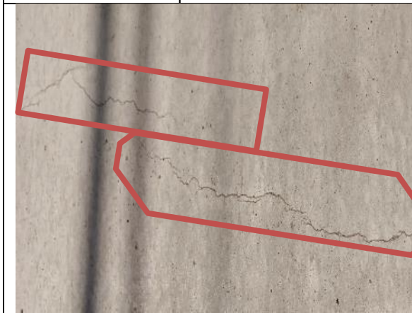
Fotografía N° 27 de 07-02-2023: Fisura en aceras de hormigón, tramo 9 calle Aníbal Pinto entre San Martín y Serrano, acera poniente, (altura N° 419)
