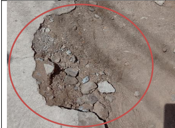
Fotografía N° 21 de 07-02-2023: Hormigón Desconchado en acera, tramo 7 calle Patricio Lynch entre Thompson y Almirante Latorre acera poniente (altura N°739).
