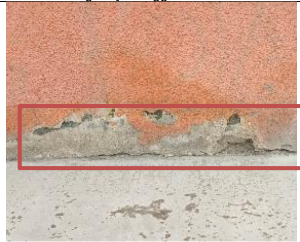
Fotografía N° 10 de 31-01-2023: Daño en fachada, tramo 11 calle Aníbal Pinto entre Zegers y O'Higgins poniente.
