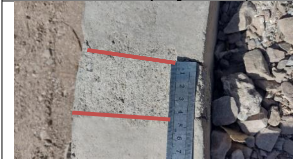
Fotografía N° 11 de 21-02-2023: separación entre soleras superior a 5mm, tramo 11 calle Aníbal Pinto entre Grumete Bolados y Zegers, acera poniente.
