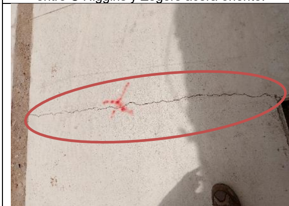
Fotografía N° 17 de 07-02-2023: Grieta en hormigón en acera, tramo 11 calle Aníbal Pinto entre Zegers y Wilson acera oriente
