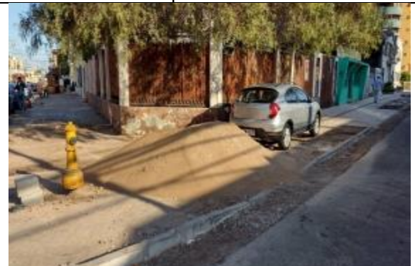
Fotografía N° 6 de 21-02-2023: acopio de material granular sin protección y sin delimitación de seguridad, tramo 8 calle Patricio Lynch entre Gorostiaga y Wilson, acera poniente.
