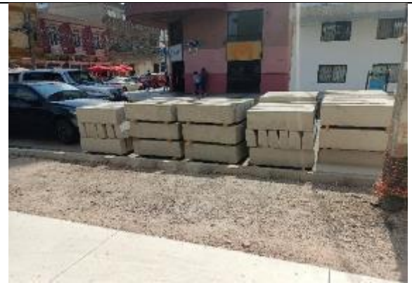
Fotografía N° 2 de 31-01-2023: acopio de soleras sin protección y sin delimitación de seguridad, tramo 9 calle Aníbal Pinto entre San Martín y Serrano, acera poniente.
