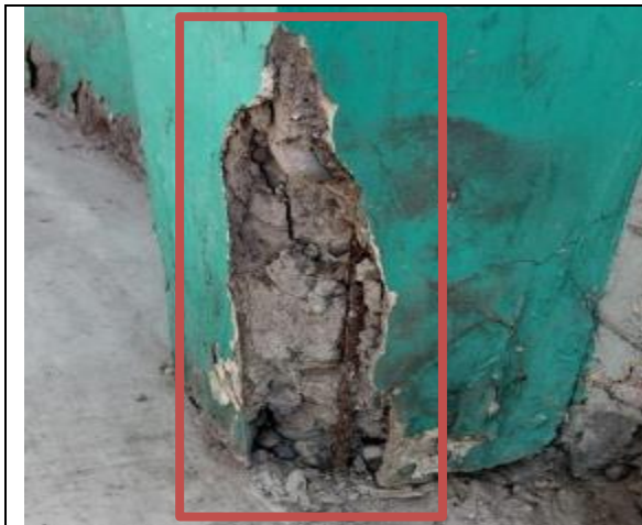
Fotografía N° 7 de 20-02-2023: Daño en fachada, tramo 8 calle Patricio Lynch entre Wilson y Gorostiaga, acera poniente.
