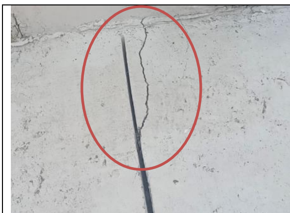
Fotografía N° 13 de 07-02-2023: Grieta en hormigón en acera, tramo 9 calle Aníbal Pinto entre Bolívar y San Martín acera poniente
