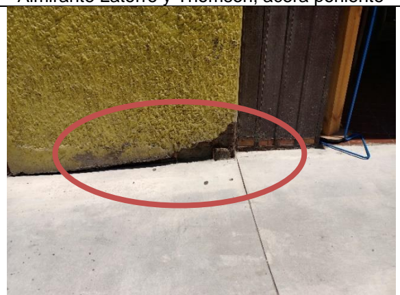
Fotografía N° 6 de 20-02-2023: Daño en fachada, tramo 8 calle Patricio Lynch entre Gorostiaga y Almirante Latorre, acera poniente.
