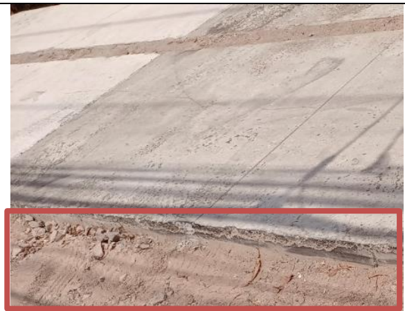
Fotografía N° 32 de 07-02-2023: Perdida de arista en aceras de hormigón, tramo 11 calle Aníbal Pinto entre Zegers y O'Higgins, acera poniente.
