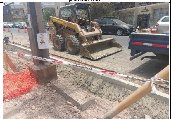
Fotografía N° 6 de 31-01-2023: maquinaria sin señal de tránsito PT-4 y letrero de advertencia de peligro no cumple con lo indicado en el MST (PTE-12), tramo 9 calle Aníbal Pinto entre Gorostiaga y Wilson, acera poniente.
