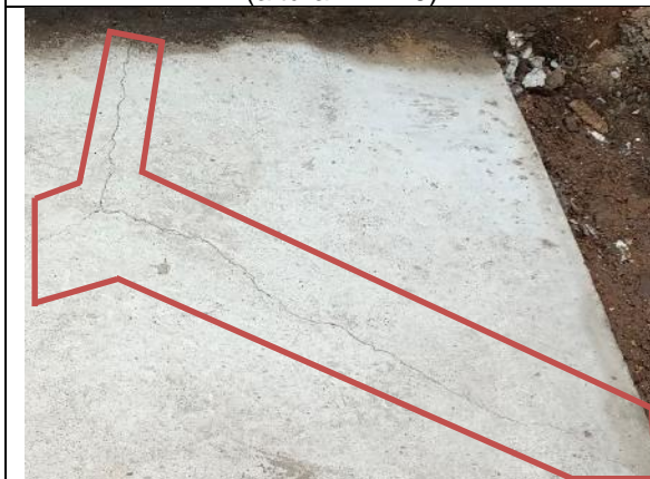
Fotografía N° 29 de 07-02-2023: Fisura en aceras de hormigón, tramo 11 calle Aníbal Pinto entre Zegers y Wilson, acera oriente, (altura N°962)
