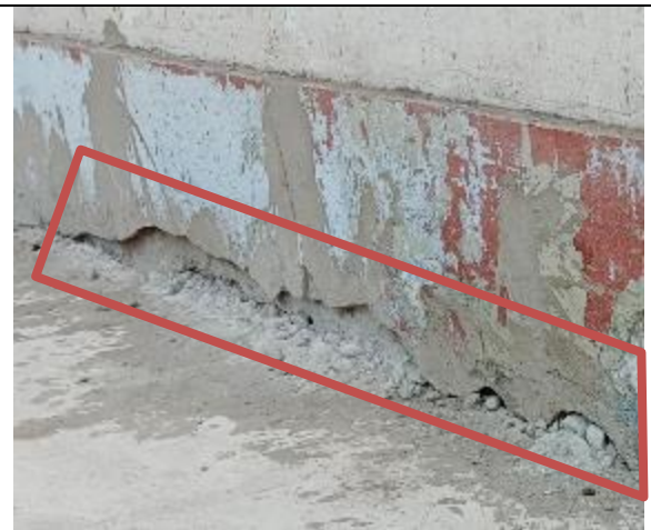
Fotografía N° 8 de 31-01-2023: Daño en fachada, tramo 11 calle Aníbal Pinto entre Zegers y O'Higgins oriente.
