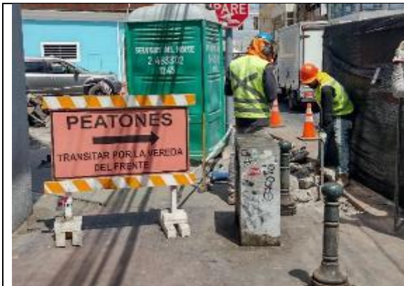
Fotografía N° 1 de 31-01-2023: no se encuentran instalados los letreros de señalización de trabajos en la vía PT-1 y PT-2, tampoco la señal de angostamiento a la derecha PTF-1b, tramo 8 calle Patricio Lynch entre Almirante Latorre y Gorostiaga, acera oriente.
