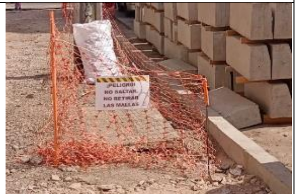
Fotografía N° 4 de 31-01-2023: letrero de advertencia de peligro no cumple con lo indicado en el MST (PTE-12), tramo 9 calle Aníbal Pinto entre San Martín y Serrano, acera poniente.
