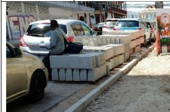
Fotografía N° 3 de 07-02-2023: acopio de soleras sin protección y sin delimitación de seguridad, en la misma zona que la fotografía 138, tramo 9 calle Aníbal Pinto entre San Martín y Serrano, acera poniente.
