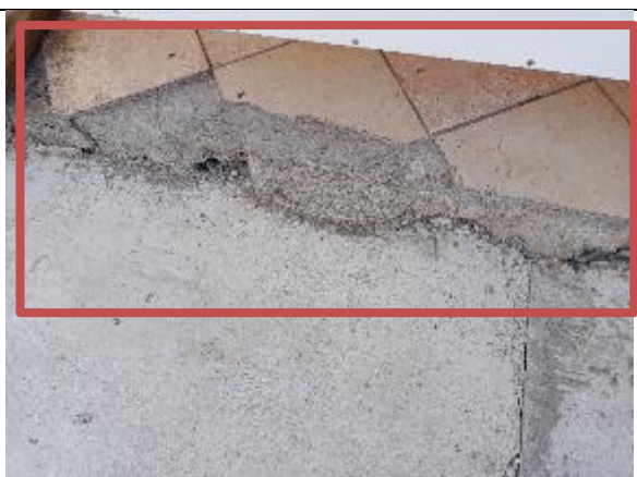
Fotografía N° 2 de 20-02-2023: Daño en fachada, tramo 7 calle Patricio Lynch entre Almirante Latorre y Thomson, acera poniente.
