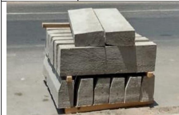
Fotografía N° 5 de 15-02-2023: acopio de soleras sin protección y sin delimitación de seguridad, tramo 11 calle Aníbal Pinto entre Grumete Bolados y Zegers, acera poniente.
