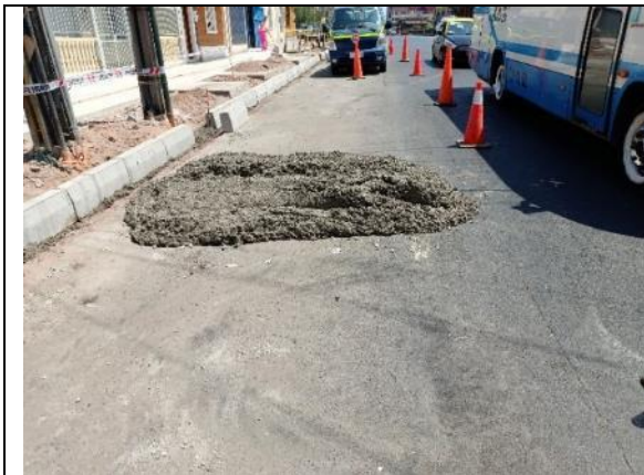
Fotografía N° 7 de 07-02-2023: cierre provisorio, tramo 10 calle Aníbal Pinto entre Gorostiaga y Wilson, acera poniente.
