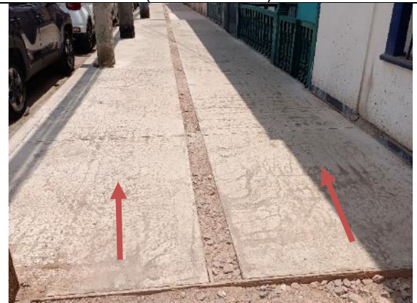
Fotografía N° 24 de 15-02-2023: Manchas en aceras de hormigón, tramo 8 calle Patricio Lynch entre Wilson y Gorostiaga acera oriente, ambos paños.
