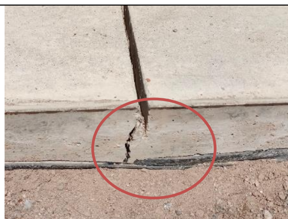
Fotografía N° 14 de 07-02-2023: Grieta en hormigón en acera, tramo 9 calle Aníbal Pinto entre San Martín y Serrano acera poniente.
