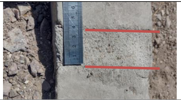
Fotografía N° 10 de 21-02-2023: separación entre soleras superior a 5mm, tramo 11 calle Aníbal Pinto entre Grumete Bolados y Zegers, acera poniente.
