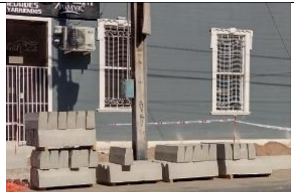
Fotografía N° 4 de 07-02-2023: acopio de soleras sin protección y sin delimitación de seguridad, en la misma zona que la fotografía 138, tramo 9 calle Aníbal Pinto entre Gorostiaga y Wilson, acera poniente.
