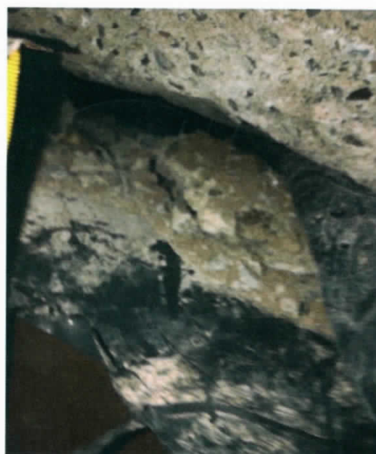
Figura N°4 Socavación suelo de Fund. Cimiento
