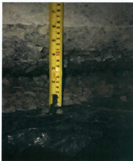
Figura N°3 Asentamiento casi 10 cm
