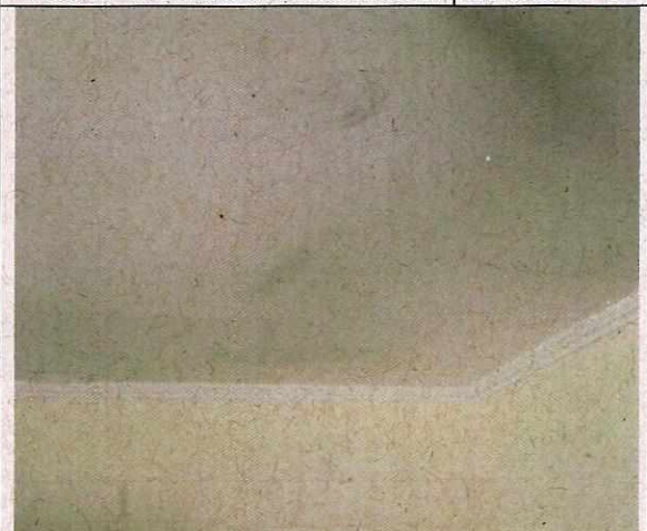
Foto N° 6: Cielo con humedad
