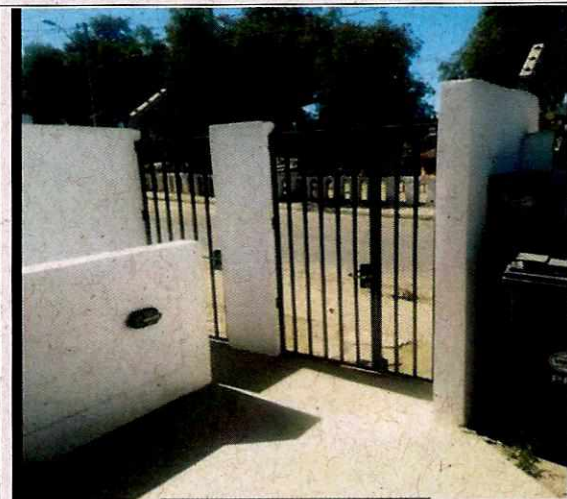
Foto N° 16: CVT falta de señaléticas en vías de evacuación
