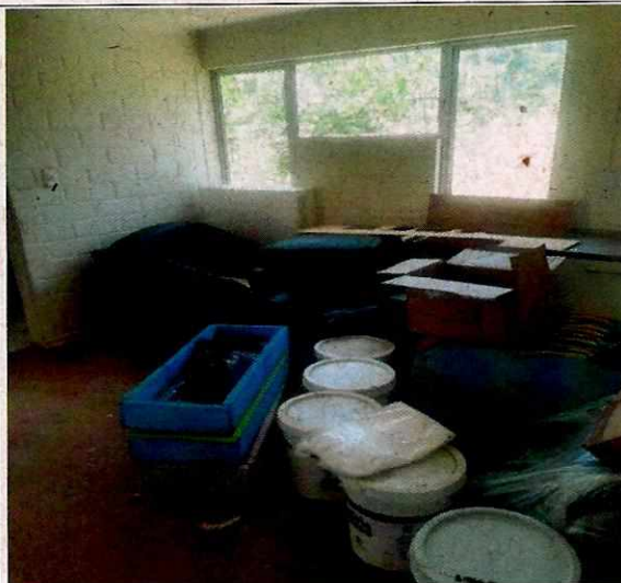
Foto N° 14: Casa N° 15, dispuesta como bodega y sin mantención
