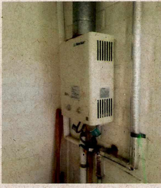
Foto N° 12: Calefont en mal estado de conservación casa N° 1
