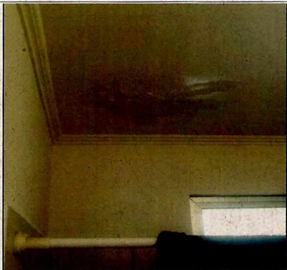
Foto N° 7: Cielo con humedad
