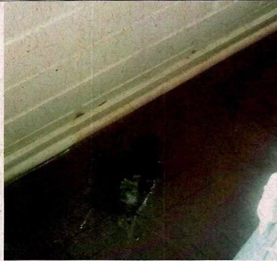
Foto N° 3: Deficiente recubrimiento piso casa N° 3
