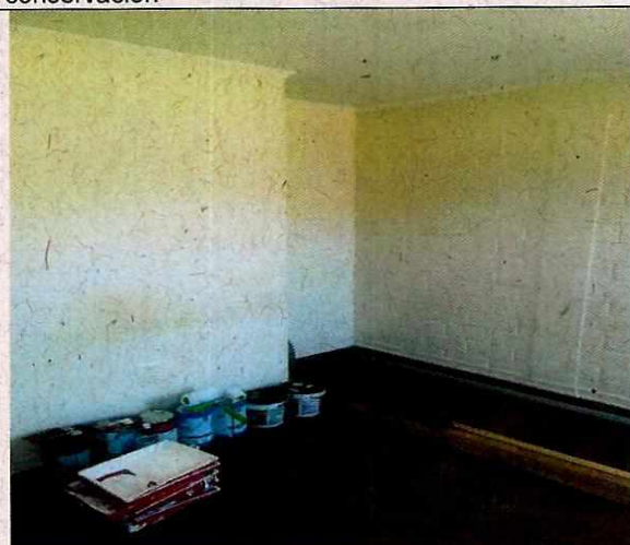
Foto N° 15: Casa N° 15, dispuesta como bodega y sin mantención
