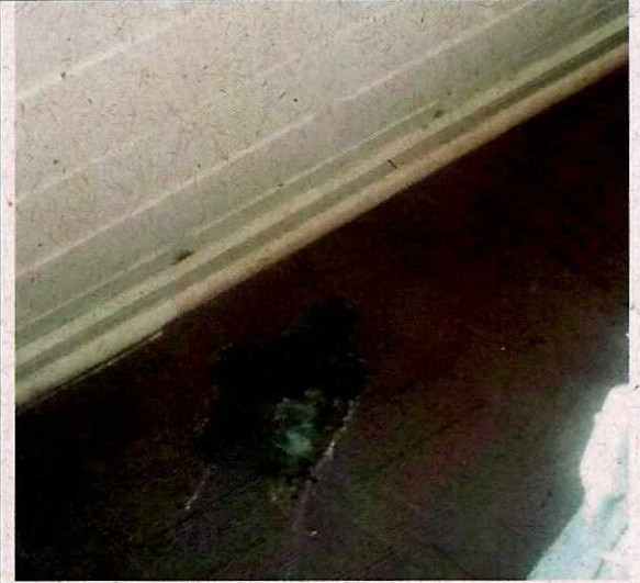
Foto N° 4: Deficiente recubrimiento piso casa N° 3
