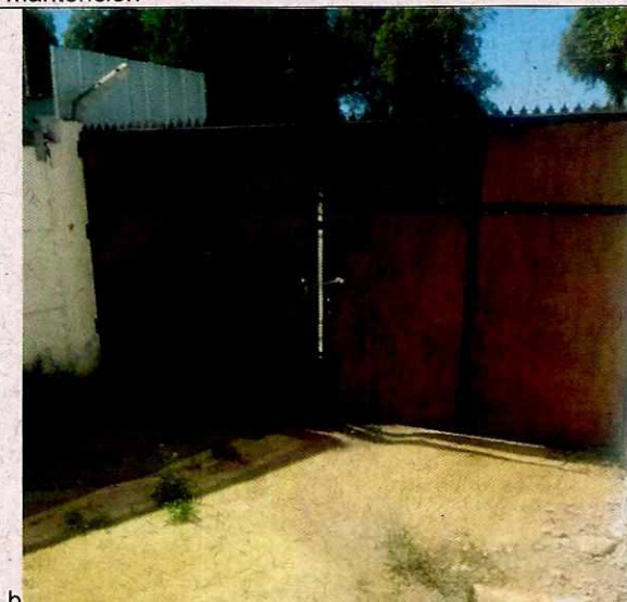
b Foto N° 17: CVT falta de señaléticas en vías de evacuación
