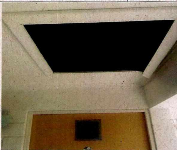
Foto N° 5: Abertura de cielo en pasillos del CVT
