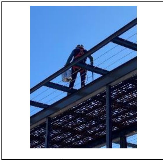
Imagen N°: 3 Fecha captura: 11 de agosto de 2025 Ubicación: Parque kaukari 3° Etapa 3A. Contenido: Trabajadores sin cuerda de vida fijada a la estructura.
