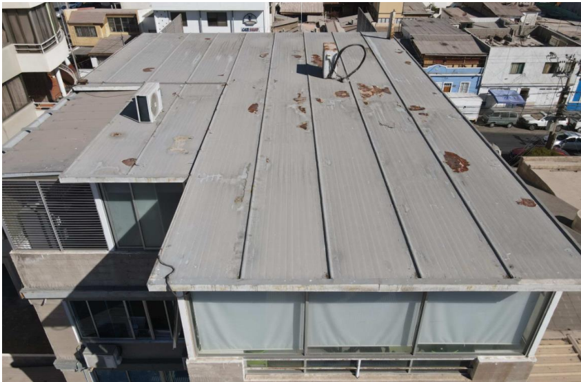
Fig. 02. Estado actual de la cubierta.
