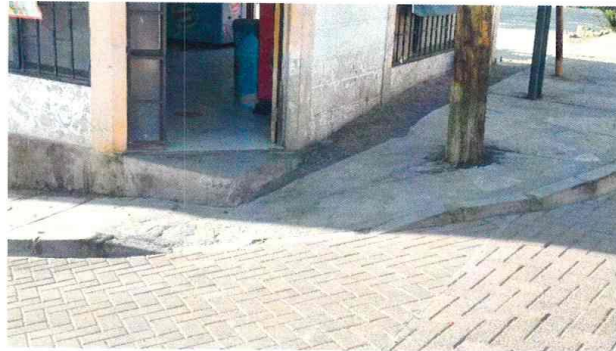
Desnivel existente en veredas de calle Huaytiquina
