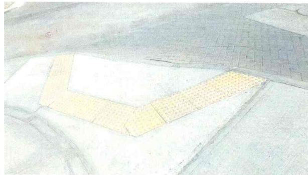
Dispositivo existente en buen estado (1)
