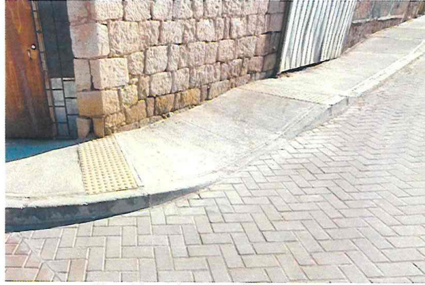
Dispositivo existente en buen estado (2)
