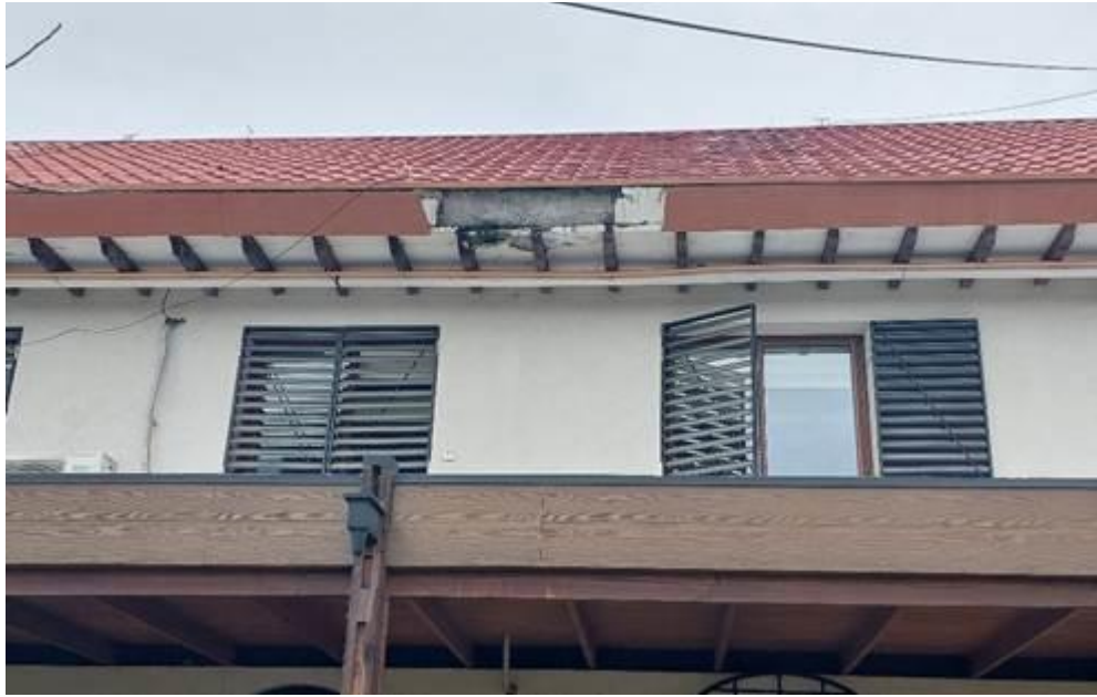
Alero con tapacón dañado, a reparar.
