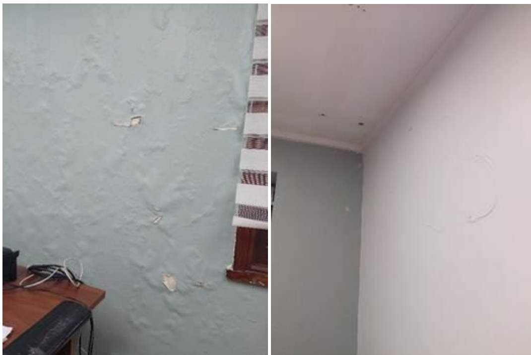
Imagen referencial, muros y cielos soplados y manchados.
