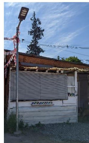
Fotografía N° 8 Asentamiento Precario Galvarino, comuna La Florida Contenido Iluminación peatonal fotovoltaica
