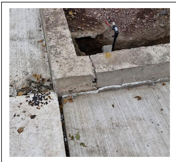
Fotografía N° 2 Fecha de captura 20-05-2024 Ubicación Solera señalada en figura N° 2 de este anexo. Contenido Pérdida de forma del hormigón.
