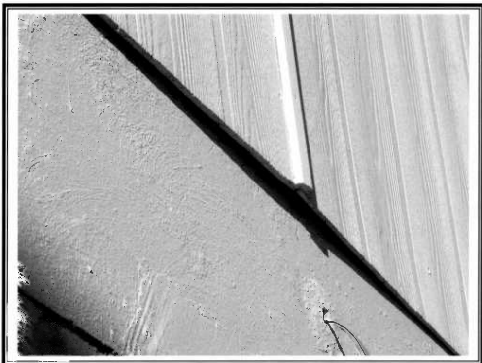
Planchas de fibrocemento texturado separadas.
