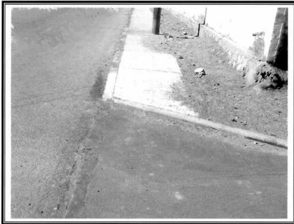
Defecto de unión de pavimento de calzada de Pasaje Labrar (1 foto)
