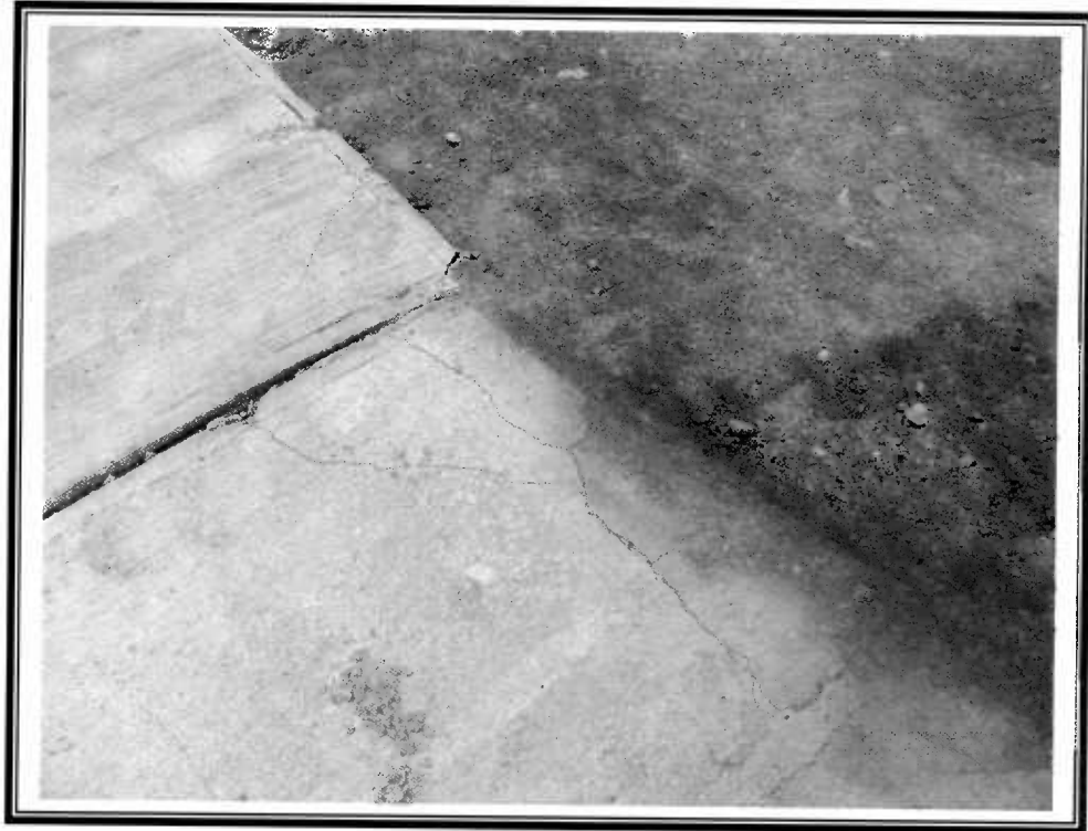
Pavimento de aceras de hormigón nuevo y deformado, calle Juan Godoy de El Salado.
