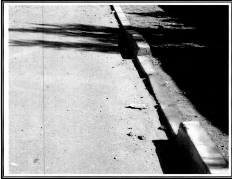
El rebaje de soleras en Pasaje Labrar, no cumple con las exigencias técnicas del proyecto (2 fotos).
