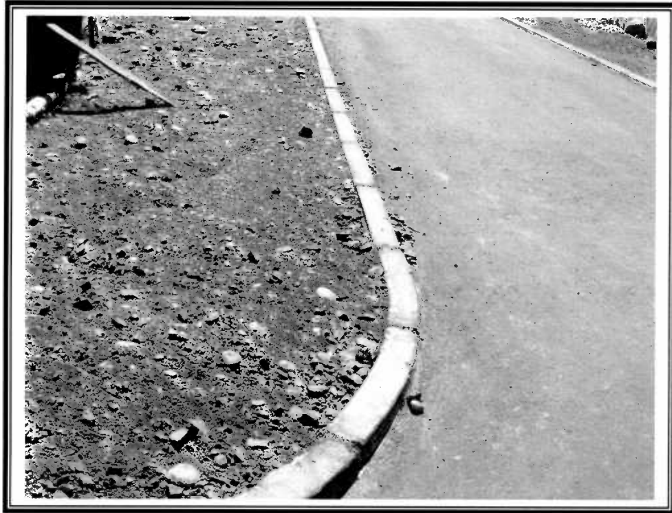
Fallas en juntas y emboquillado de soleras tipo A (3 fotos)
