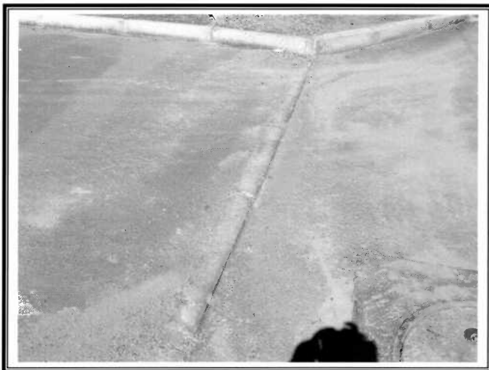
Existencia de soleras en unión de pavimento de calzada de Pasaje Labrar (1 foto)
