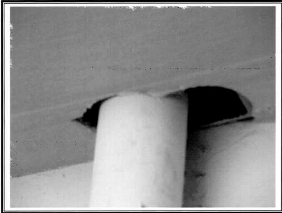
Doble perforación en cubierta de alero de algunas viviendas, en el paso de tubería de ventilación.
