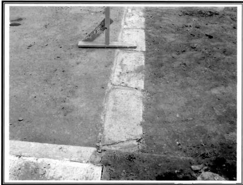
Terminación irregular de empalme de pavimento de calzada asfalto en calles de El Salado.
