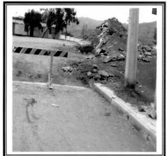
Falta retiro de escombros en Caldera y El Salado.
