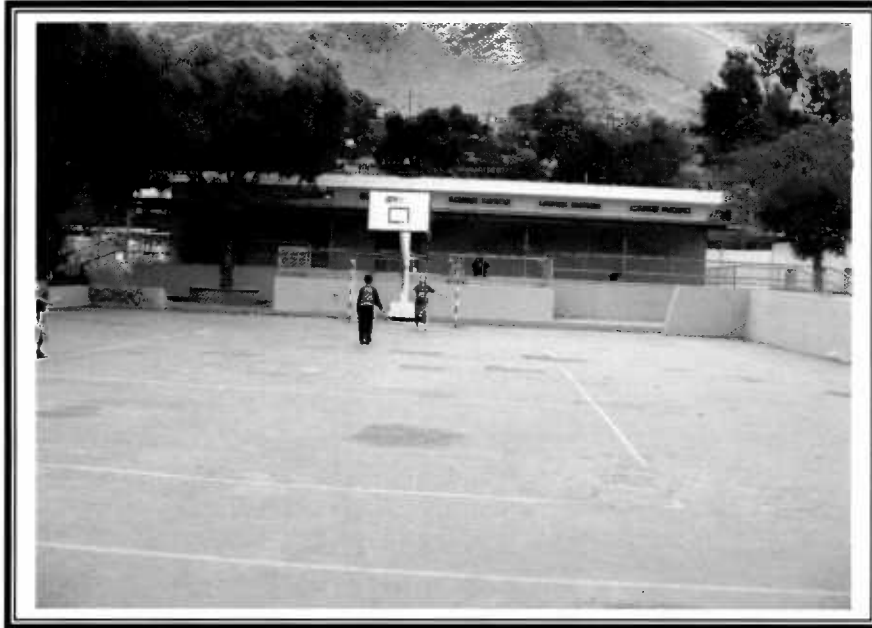
Fallas en pavimento de multicancha
