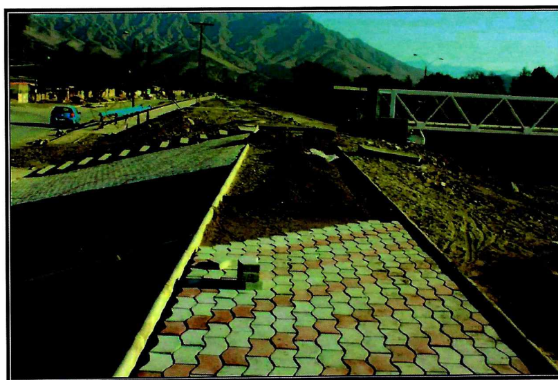
Fotografías N°s. 3 y 4 “Pavimento de adocreto y solerillas sin terminar”.
