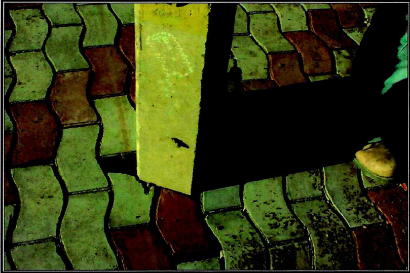
Fotografías N°s. 21 y 22 “Postes eléctricos sin tazón cuadrado”.
