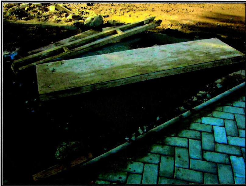
Fotografías N°s. 19 y 20 “Vías de tránsito ocupadas con materiales y falta de señalización de advertencia de peligro”.
