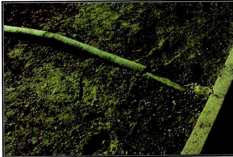
Fotografías N°s. 47 y 48 “Solerillas mal terminadas y desalineadas”.
