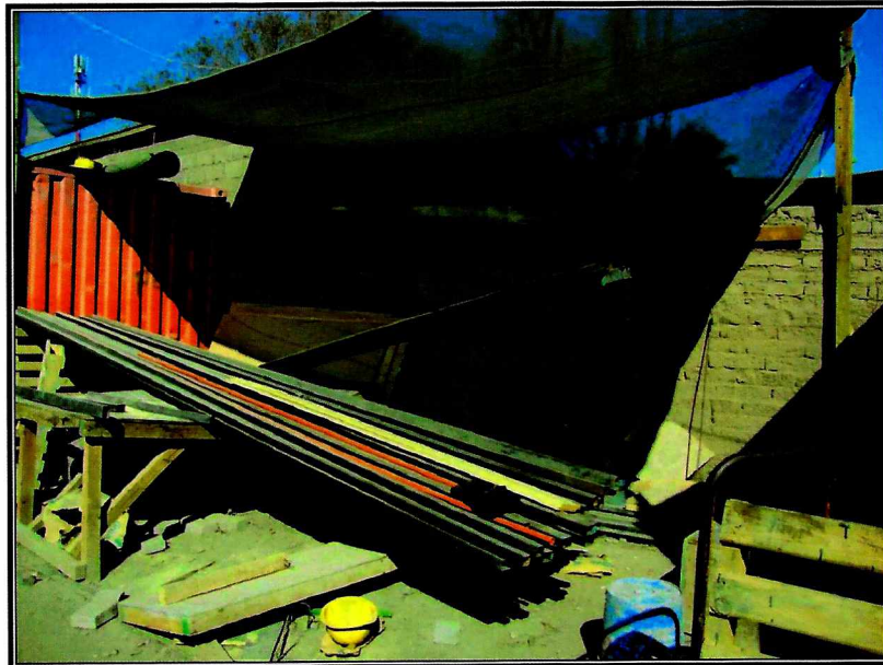
Fotografías N°s. 13 y 14 “Falta comedor para personal”.
