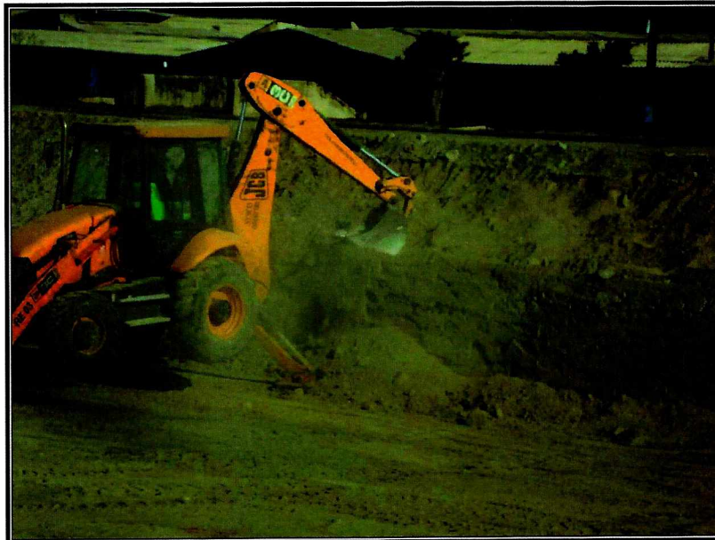
Fotografías N°s. 37 y 38 “Deterioro de obras de pavimentación y trabajos de nivelación sobre muro de mampostería terminado”.
