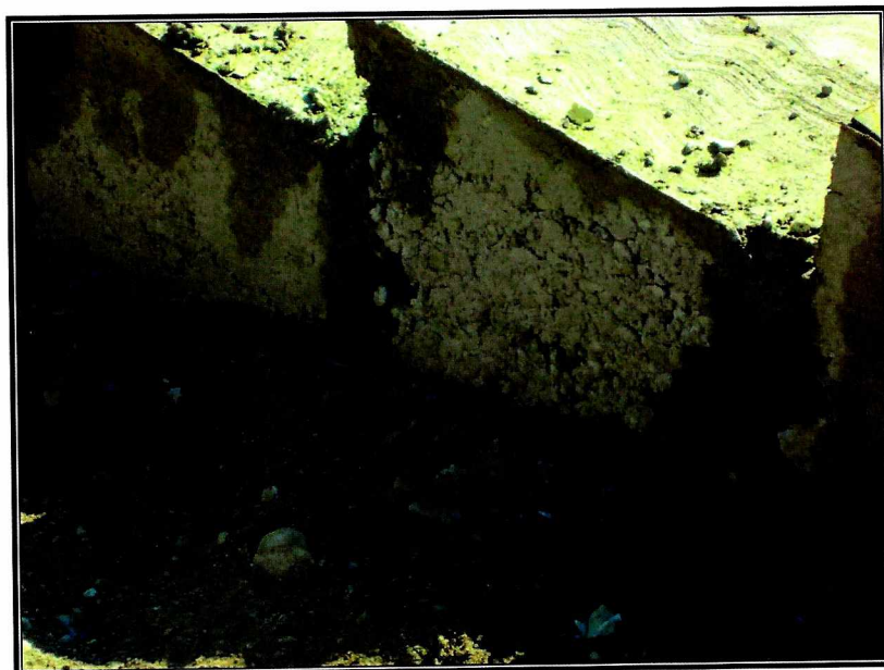
Fotografías N°s. 55 y 56 “Escaleras con nidos de piedra y desagregación de material”.
