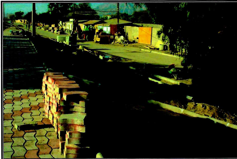
Fotografías N°s. 1 y 2 “Falta señalización provisoria de proximidad de peligro”.
