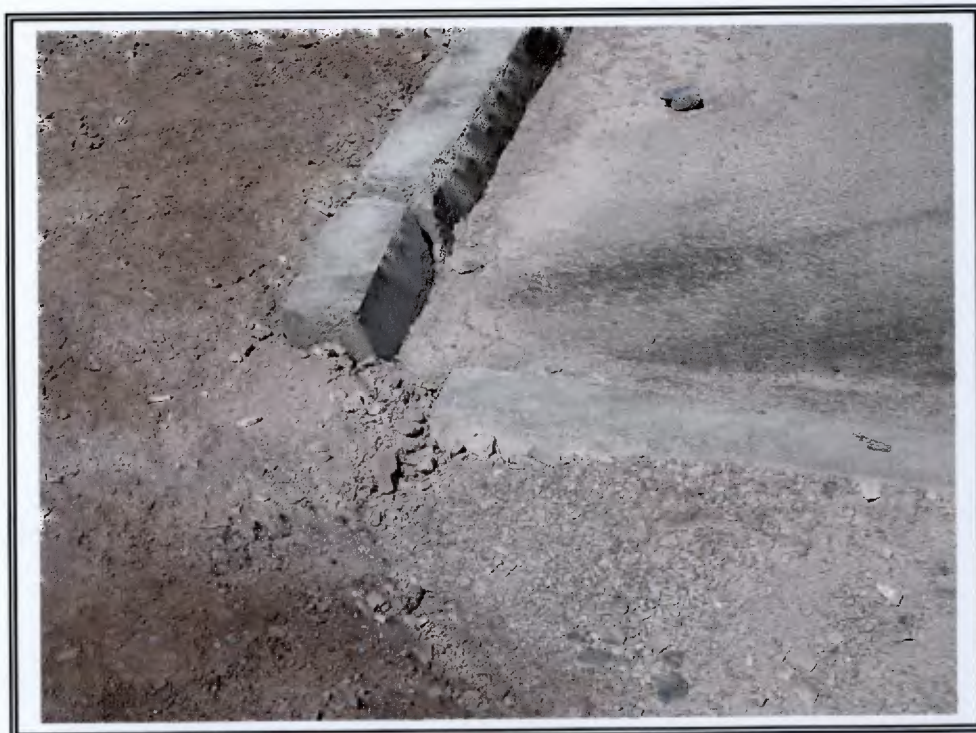
Foto N° 11 Solera removida al extremo de calle Copiapó.
