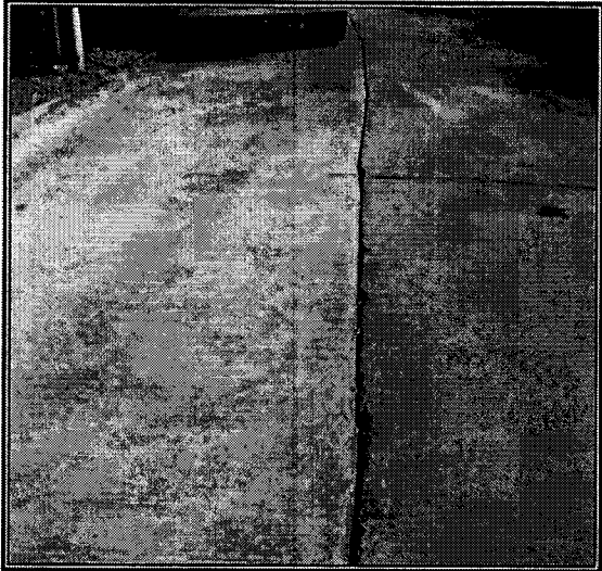
Foto N° 45 Isla de Pascua, irregular separación entre pavimento nuevo y existente
