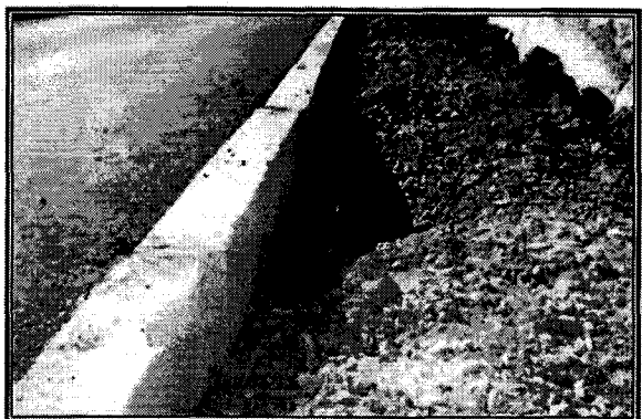
Foto N° 18 Lircay, soleras desalineadas y sin respaldo
