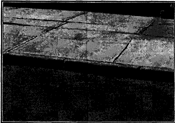
Foto N° 23 Arturo Prat, emboquillados desprendidos
