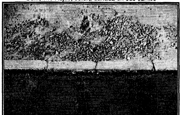
Foto N° 30 Lircay N° 920, solera quebrada
