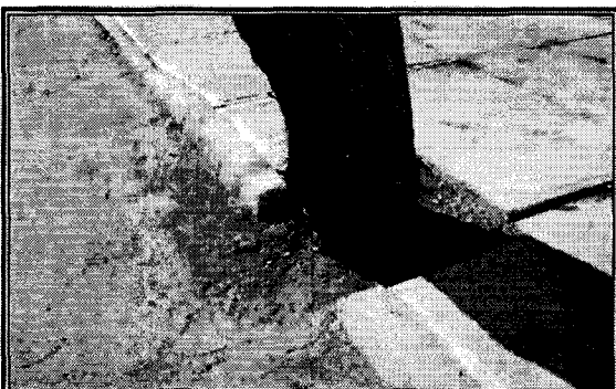
Foto N° 21 Sargento Aldea, frente a la multicancha, solera sin ejecutar
