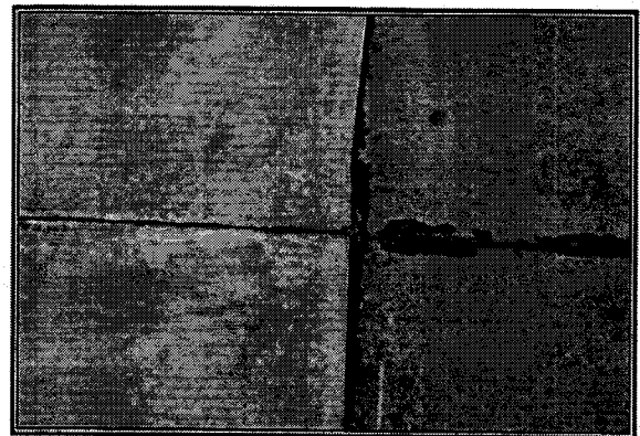
Foto N° 44 Isla de Pascua, excesiva separación entre pavimento nuevo y existente
