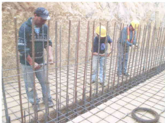
Foto N° 4 Trabajadores sin elementos de seguridad
